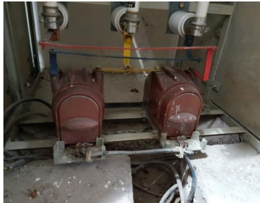
Figura 3.4. Transformadores de Potenciales. (Fuente Autores)
