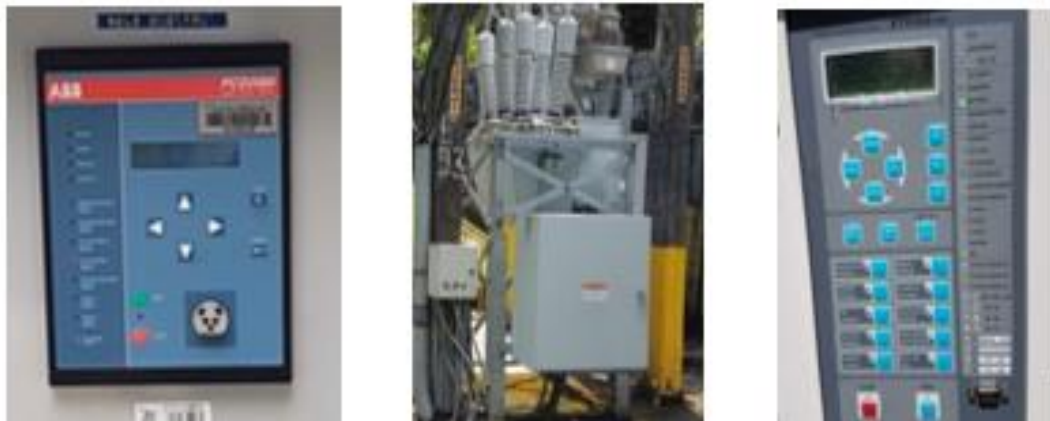
Figura 3.15. Relés de Subestación. (Fuente Autores)
