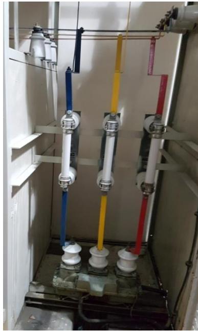
Figura 3.10. Transformadores de Potencial de la unidad de generación 3. (Fuente Autores)
