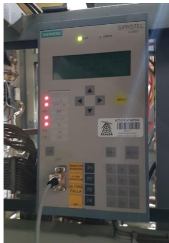
Figura 3.3. Relé instalado en unidad de generación 1. (Fuente Autores).
