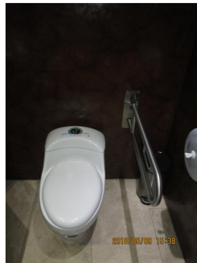
Ilustración 47: Accesorios baño PMR, Hotel Valgus Fuente: Autor Fecha: 9 mayo 2018
