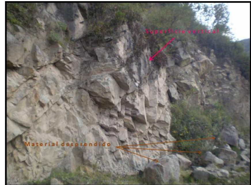
Figura 3.2.5. Tipo de fenómeno de remoción de masas: desprendimiento.
