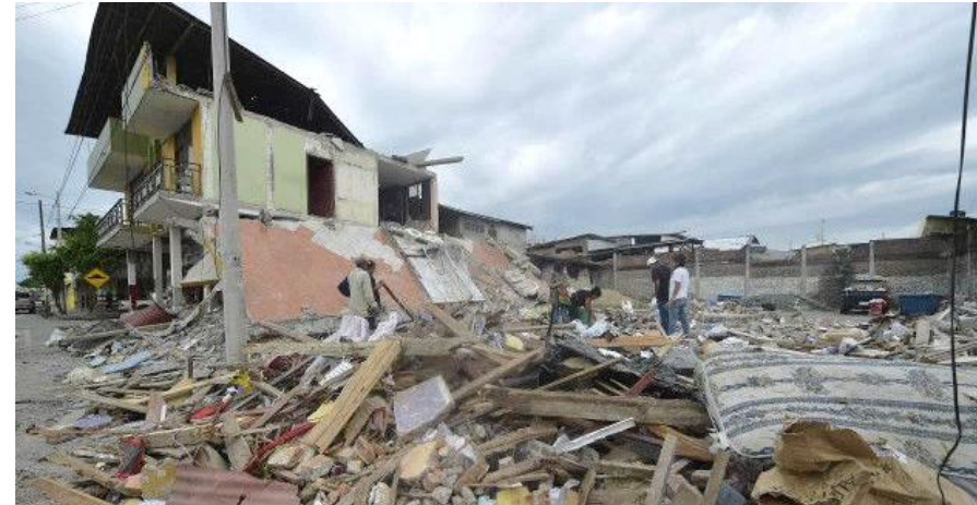
Fotografía 1.2.1. Afectación de edificación: terremoto 16 de abril 2016, Pedernales.
