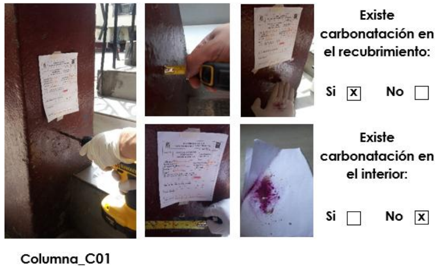
Figura 13. Ensayo en columna C1-carbonatacion
