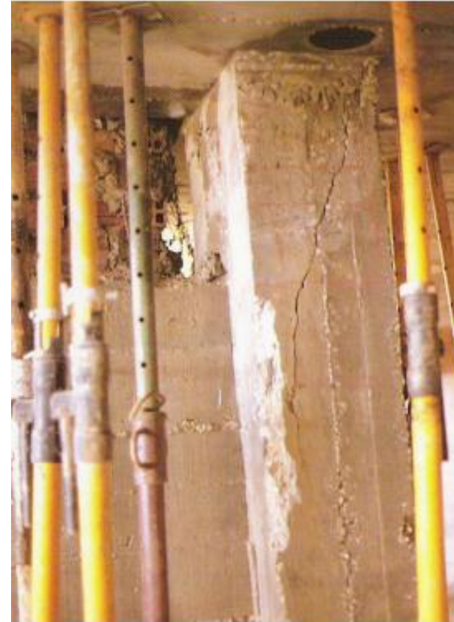
Fotografía 3. Fallos por esfuerzos de flexocompresión en columna.
