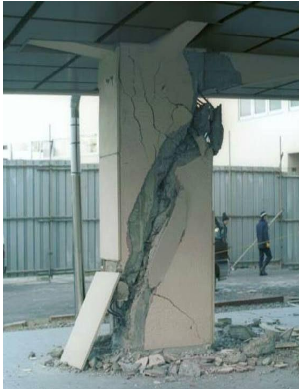
Fotografía 4. Fallo por esfuerzo cortante en columna
