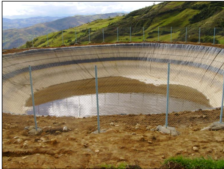
Gráfico 9. Fotografía del reservorio del sistema de riego Cachiguzo. 2009
