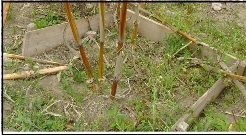
FOTOGRAFÍA 16. Ecuador, obra de conservación, microcuenca Cachihuayco, provincia - Cañar Elaborado por: Cajamarca E., Macancela G.
