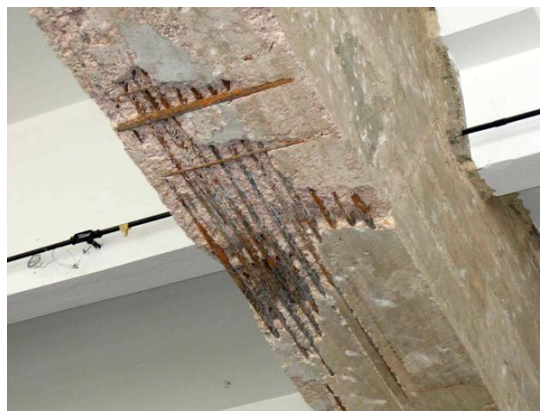
Figura 5. Acero de refuerzo corroído.
