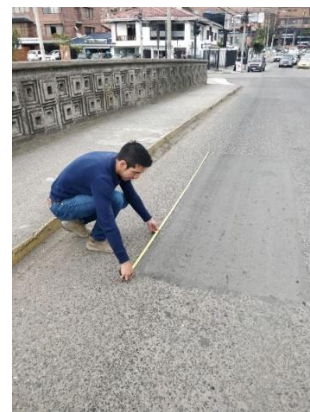
Levantamiento de deterioros en pavimento
