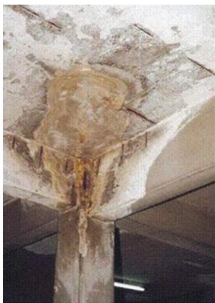
Figura 4. Reacción del hormigón debido a ataques químicos.
