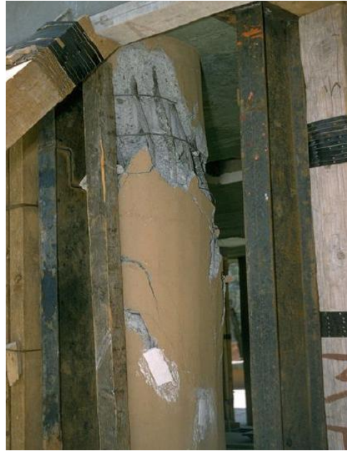
Figura 13. Colapso de columna debido a sismo.
