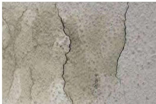
Figura 7. Fisuras por retracción plástica.
