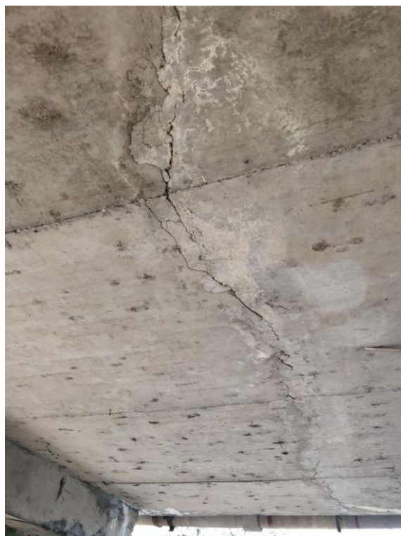
Figura 66. Fisura en tablero
