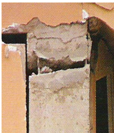
Figura 10. Falla de columna debido a tracción. Fuente: Patología en las estructuras de hormigón armado, (Porto Quintián, 2005)
