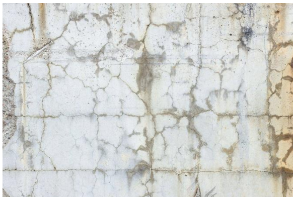
Figura 3. Acción del hielo-deshielo en el hormigón.
