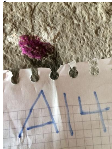
Carbonatación en el arco
