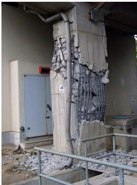
Figura 9. Colapso de columna por falla a compresión. Fuente: Los fallos del hormigón, (C.Corral, s. f.)
