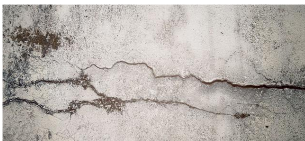
Figura 8. Grieta por contracción térmica en muro.
