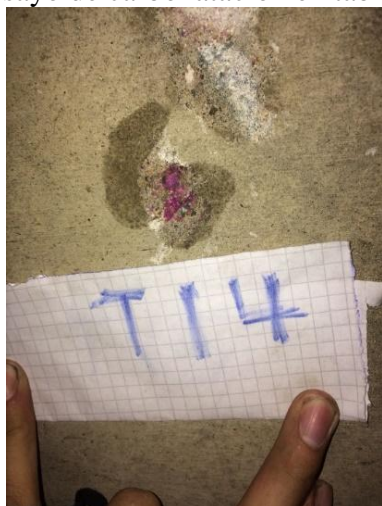
Carbonatación en tablero
