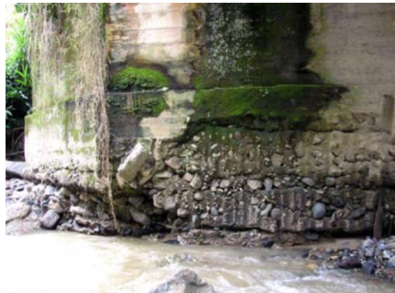
Figura 2. Erosión provocada por el agua.
