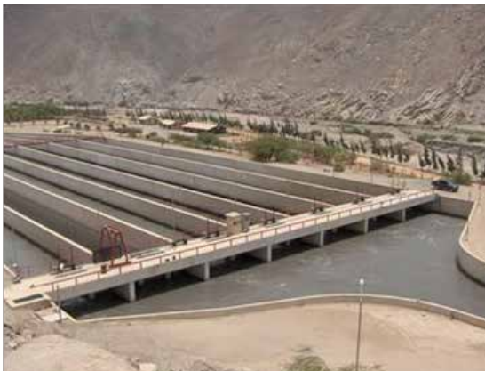
Desarenador tipo detritus Los desarenadores son obras hidráulicas que sirven para separar (decantar) y remover (evacuar) después, el material sólido que lleva el agua de un canal.
