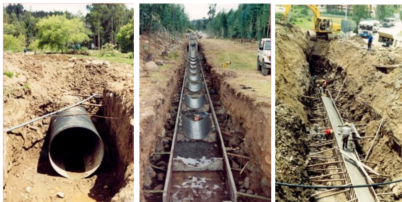
Ilustración 86: Construcción de Interceptores a lo largo de los ríos de la Ciudad de Cuenca/ Fuente: GAD Municipal del Cantón Cuenca (ETAPA EP.)
