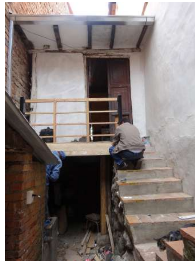
Figuras 41 y 42: Trabajos emergentes en pasamanos y pisos en la casa 08 Fuente: Proyecto vlrCPM, 2014
