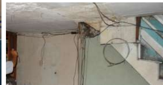
Figuras 36, 37 y 38: Instalaciones eléctricas deficientes en el manzano de San Roque Fuente: Proyecto vIirCPM, 2014
