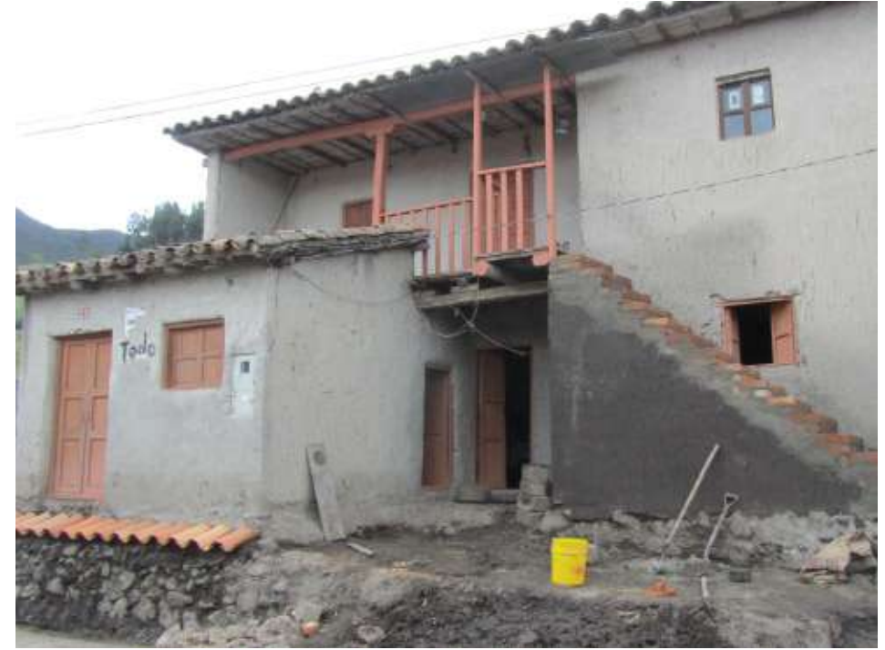
Figuras 3 y 4: Izquierda, vivienda de la señora Gerardina Déleg, con daños en la escalera, antes de la intervención. Derecha, después de la intervención Fuente: Proyecto viirCPM, 2011
