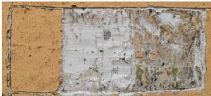
Figura 28: Cala de prospección en uno de los inmuebles intervenidos Fuente: Taller Integral de Conservación de Patrimonio, 2013
