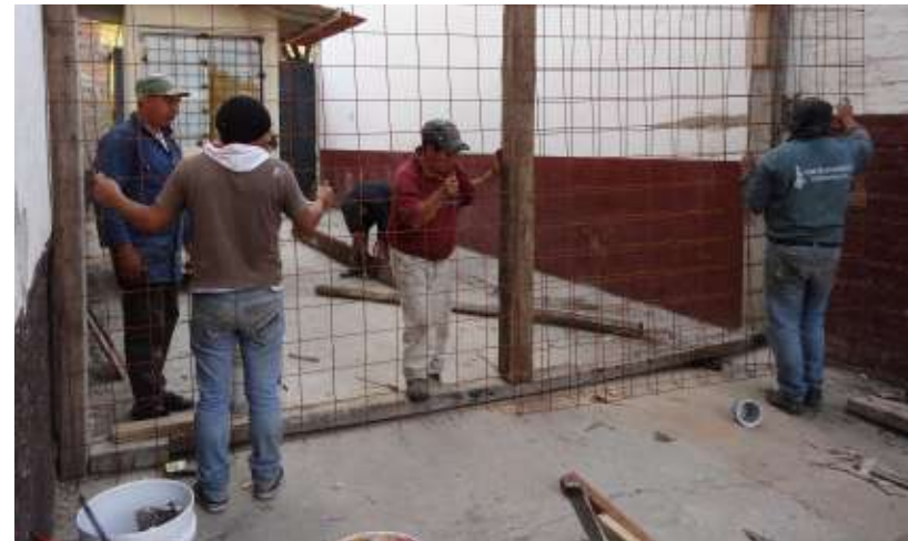
Figura 52: Construcción de la bodega de materiales para la campaña, con la colaboración del personal de obras de la Universidad Fuente: Proyecto viirCPM, 2013
