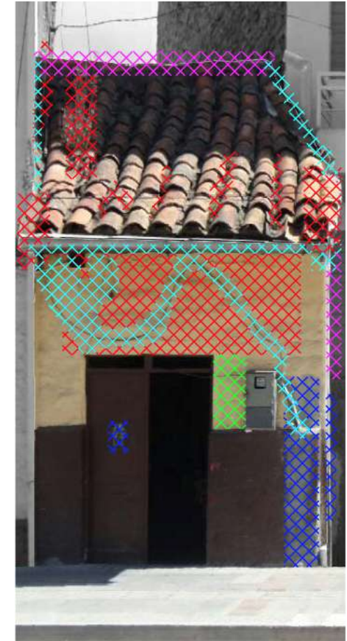
Fotografía con representación de daños
