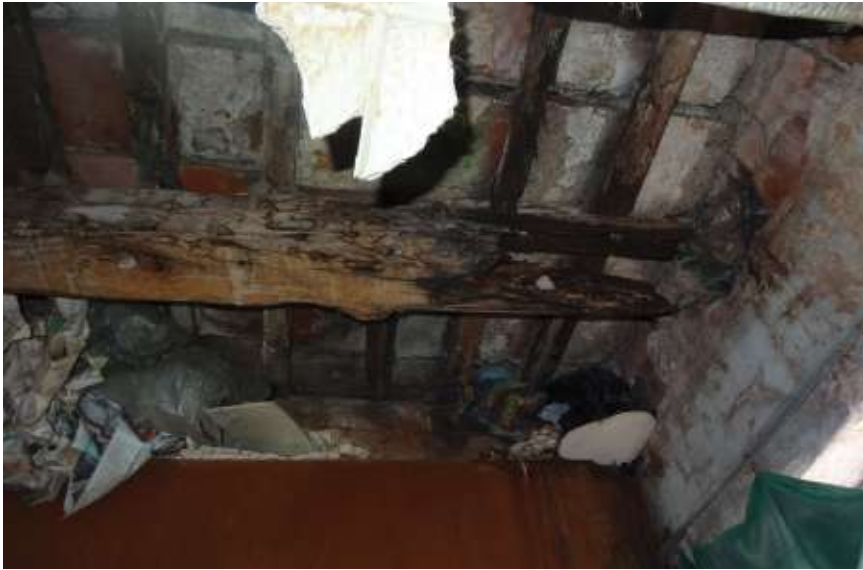
Figura 65: Daños en la estructura de la losa en la terraza de la casa Guerrero Palacios, previo a la intervención Fuente: Proyecto vIirCPM, 2013
