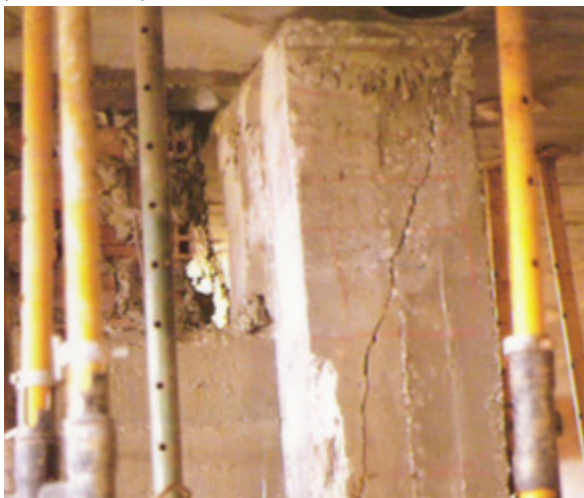
Figura 16. Aplastamiento por compresión de pilar (Porto, 2005)
