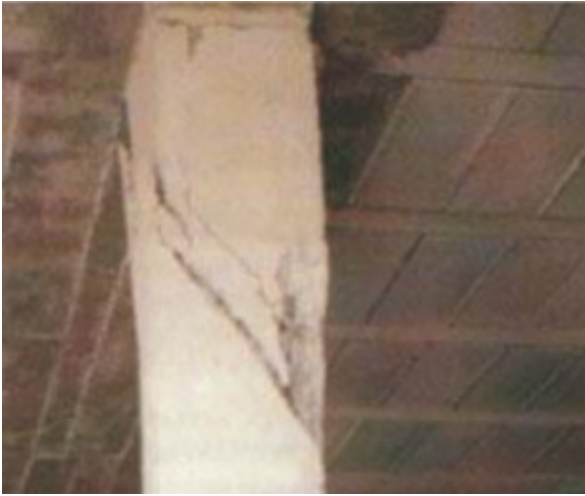
Figura 23. Rotura por cortante del pilar (Porto, 2005)
