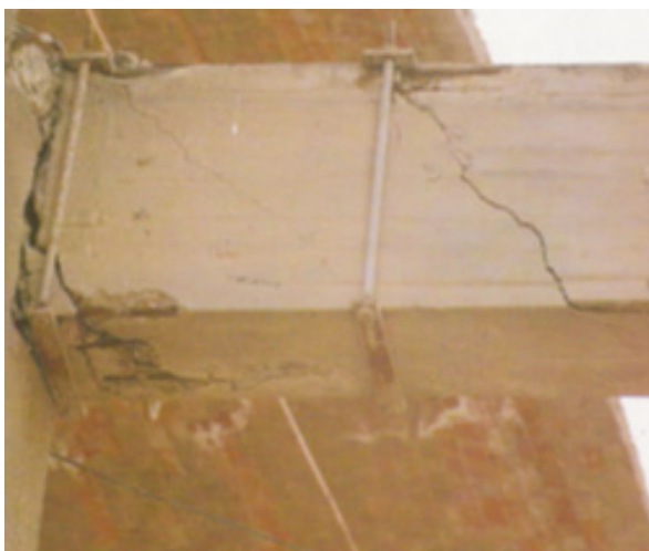
Figura 34. Rotura por torsión de una viga. (Porto, 2005)
