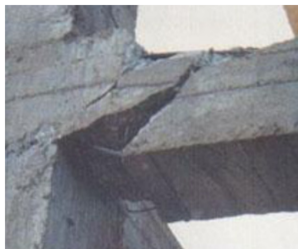
Figura 32. Rotura por cortante de una viga. (Porto, 2005)
