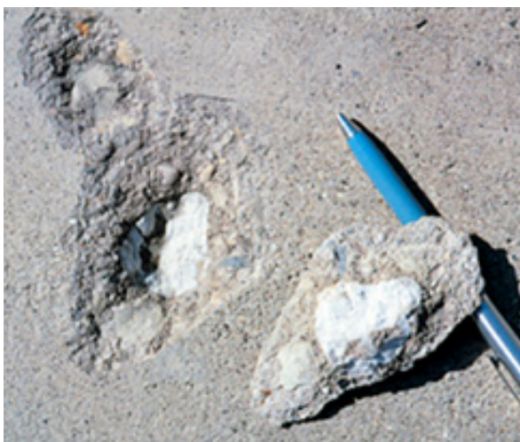
Figura 37. Pop out (Concrete Alberta, 2016)
