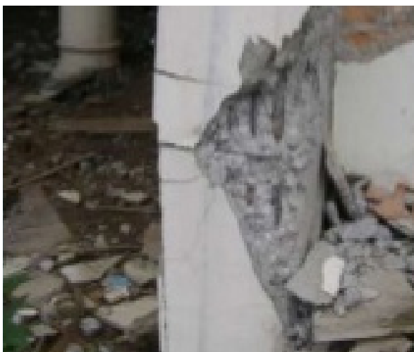
Figura 21. Rotura por pandeo del pilar (Huayanca, 2015)
