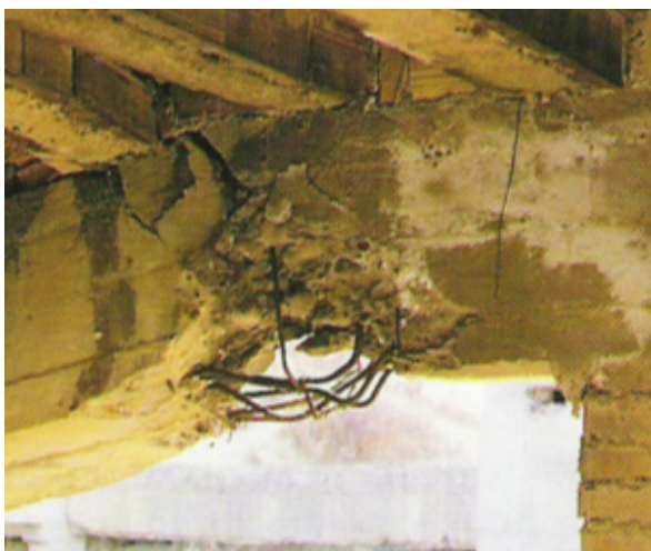
Figura 27. Aplastamiento por compresión de una viga. (Porto, 2005)
