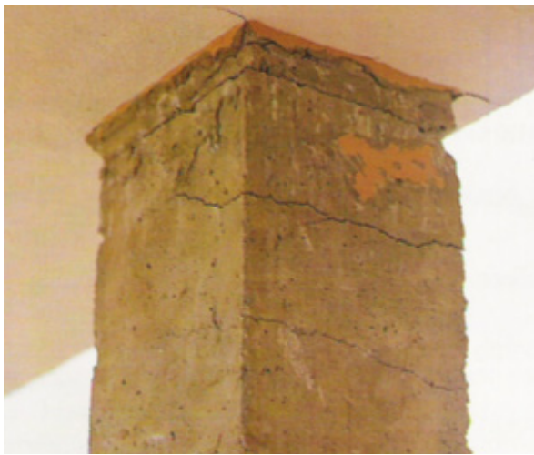
Figura 20. Rotura por flexión del pilar (Porto, 2005)
