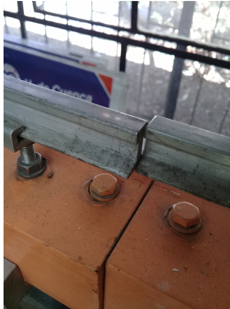
Figura 5.1: Riel dañada del canal hidrodinámico
