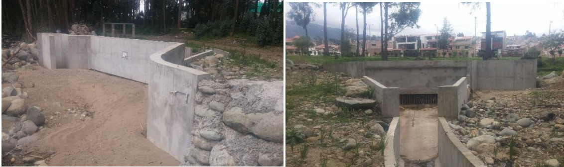
Figura. Bocatoma y transición canal multipropósito Figura. Canal curvo, canal rectangular y canal de lecho móvil
