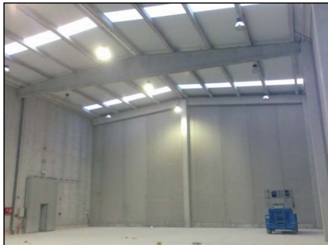
Foto. 3.1.2: Edificio industrial, Polígono Ind. Santiga-Provasa, Barberà del Vallès (Barcelona). Estructura y cerramientos de hormigón prefabricado.
