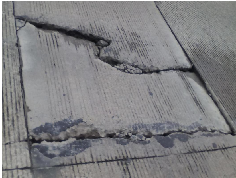
Figura 1.1 Estado actual pavimento vía Cumbe - La Jarata.
