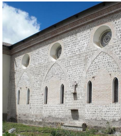
Figura 11: Fachada lateral de Santo Domingo donde se aprecia el muro portante de piedra y los huecos y arcos en ladrillo
