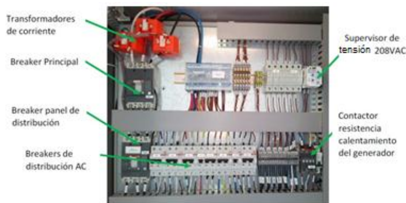
Figura 6.80: Parte interna del tablero auxiliar AC.
