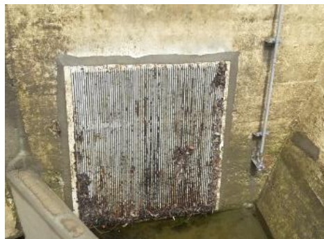
Figura 3.9: Rejilla del tanque de carga de la Mini – Central Gualaceo.
