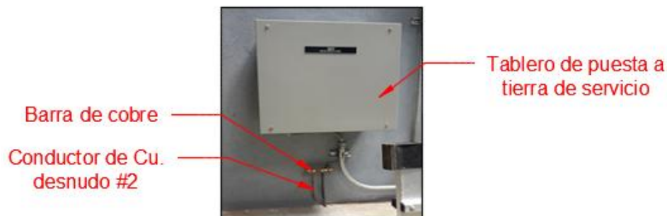
Figura 6.84: Tablero de puesta tierra.
