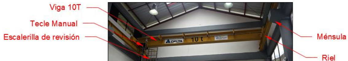
Figura 4.30: Vista frontal del puente grúa de la Mini – Central Gualaceo.
