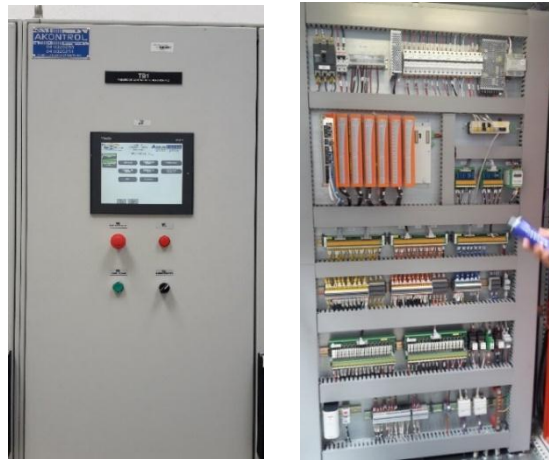
Figura 4.22: Tablero de control.
