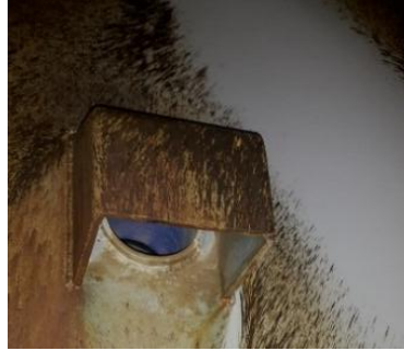
Figura 4.47: Toma de aire para evitar compresiones de aire.
