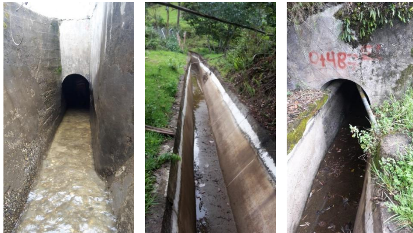
Figura 3.5: Canales y túneles de conducción de agua de la Mini – Central Gualaceo.
