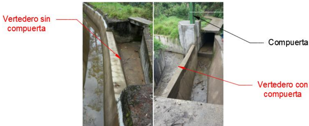
Figura 6.29: Detalle de los vertederos.
