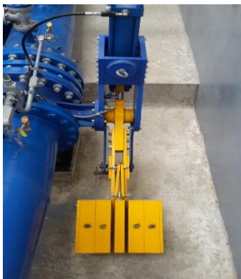
Figura 4.23: Válvula mariposa de la unidad de generación.
