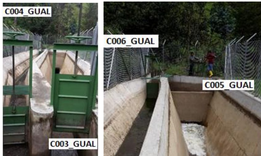
Figura 6.30: Compuertas del desarenador.
