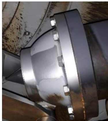
Figura 4.15: Inyectores vistos desde la parte interior de la unidad de generación.
