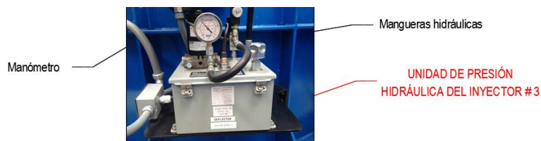
Figura 6.66: Detalle de la UHP de los Inyectores.
