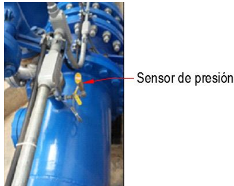
Figura 4.28: Sensores de nivel de presión del bypass.
