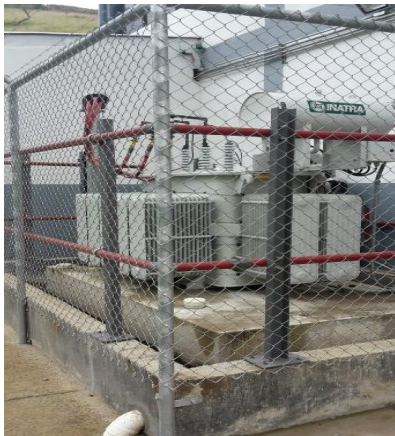
Figura 4.21: Transformador 1,25.MVA 480V/22KV.
