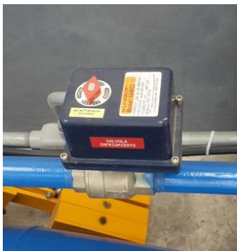
Figura 4.16: Indicador de posición válvula de enfriamiento.
