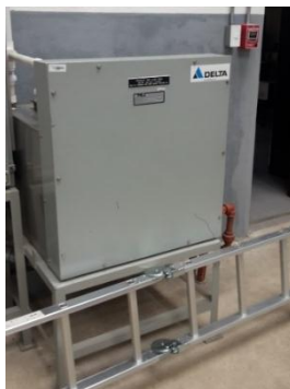
Figura 4.17: Tanque de resistencias con sistema de enfriamiento de agua.
