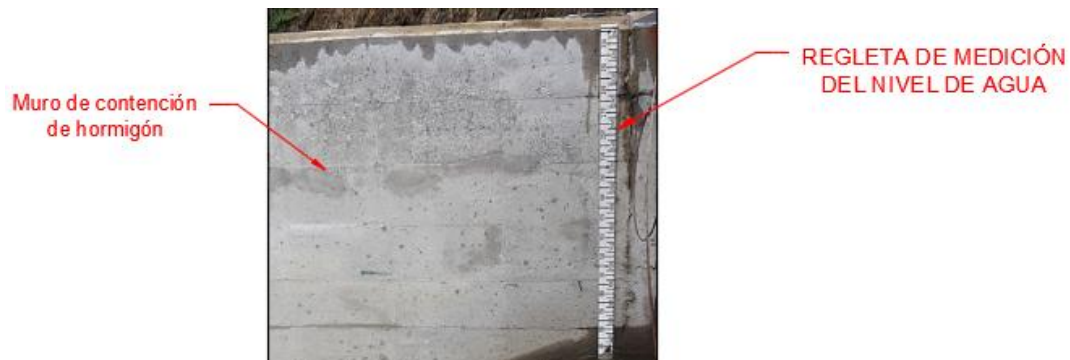
Figura 6.26: Regleta de medición de nivel de agua.
