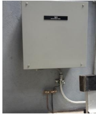
Figura 4.3: Tablero de puesta a tierra de la casa de máquinas de la Mini – Central Gualaceo.
