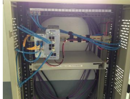
Figura 4.46: Rack de comunicaciones del tanque de carga.
