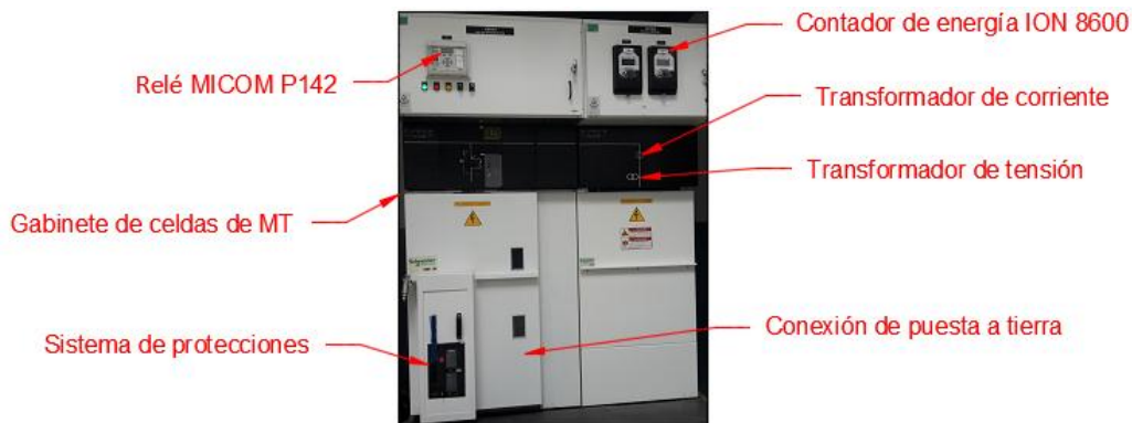
Figura 6.85: Gabinete de las celdas de media tensión.
