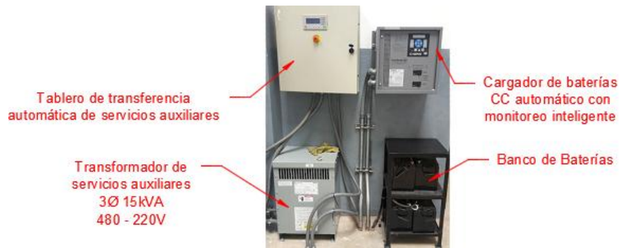
Figura 4.36: Tablero de transferencia y banco de baterías.
