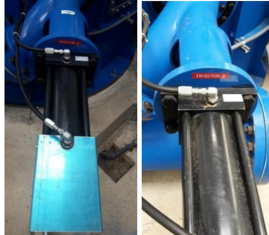
Figura 4.14: Inyectores vistos desde la parte exterior de la unidad de generación.
