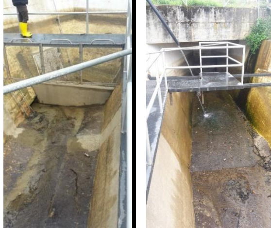
Figura 3.8: Tanque de carga de la Mini – Central Gualaceo.
