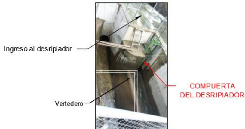
Figura 6.24: Compuerta metálica de captación.
