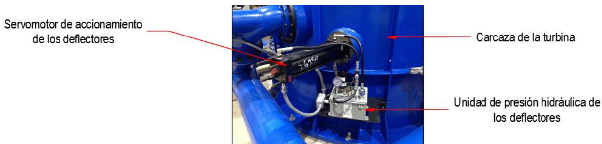
Figura 6.63: Detalle de los deflectores.
