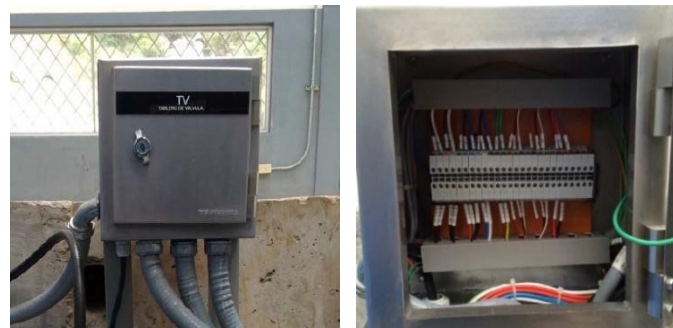
Figura 6.70: Tablero de la válvula mariposa externa e interna.
