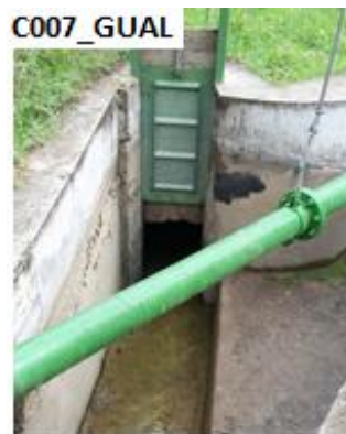
Figura 5.4: Compuerta del acueducto de la Mini – Central Gualaceo.
