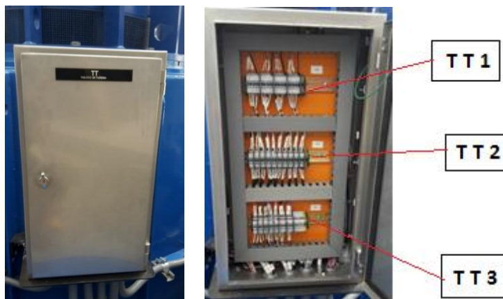
Figura 4.12: Tablero de la turbina.
