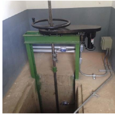
Figura 4.43: Compuerta del tanque de carga.
