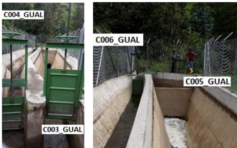
Figura 5.3: Compuertas del desarenador de la mini central.
