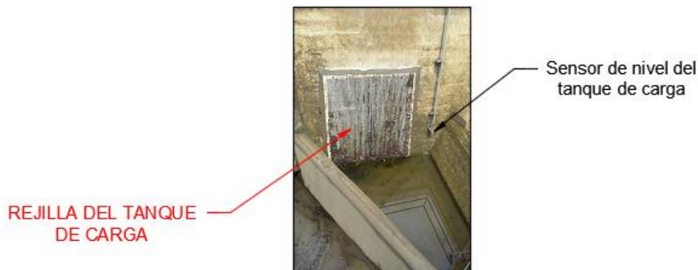
Figura 6.34: Detalle de la rejilla del tanque de carga.
