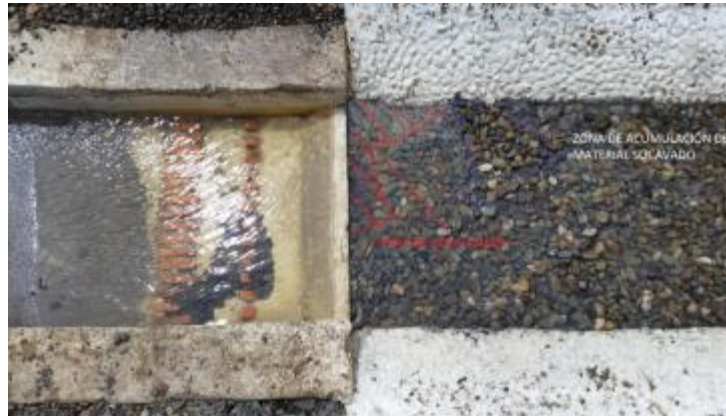
Figura. 26 Socavación en el canal de restitución. Caudal 12.52 m 3 /s. Alternativa 3-4
