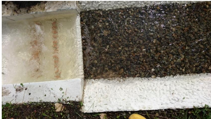
Figura. 38 Socavación en canal de restitución Alternativa 3-6
