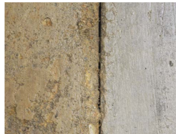
Imagen 119. Tierra y hormigón, junta constructiva por Delgado K. 2017.
