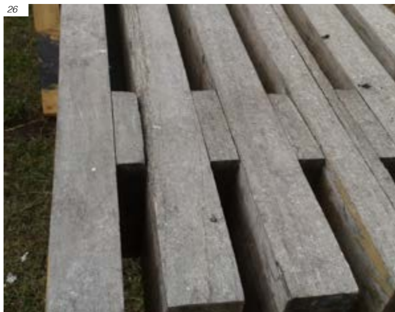
FOTO 26: Degradación de mobiliario de la Universidad de Cuenca Fuente: Autores
