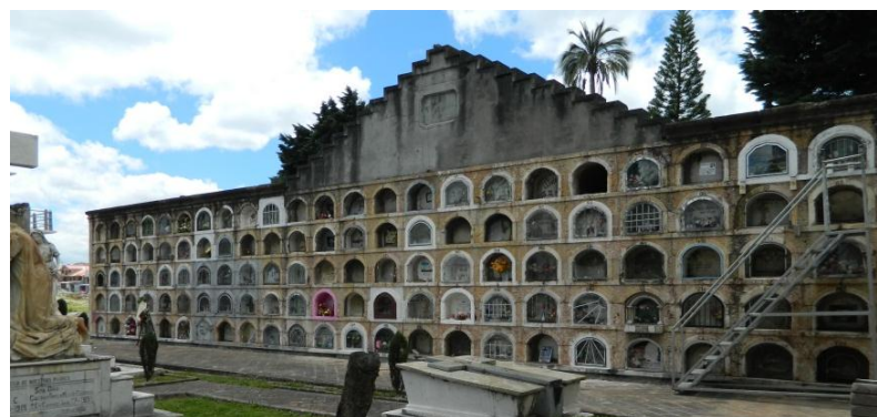
Fig. 22 Pabellón de nichos. Detalle de intervenciones inadecuadas. Fuente: Autor de la tesis. 2016
