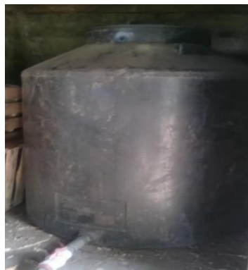
Imagen 5: Depósito de almacenamiento
