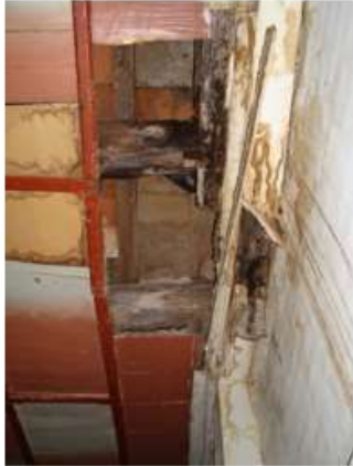
Pisos, tumbado y cielo rasos en mal estado.
