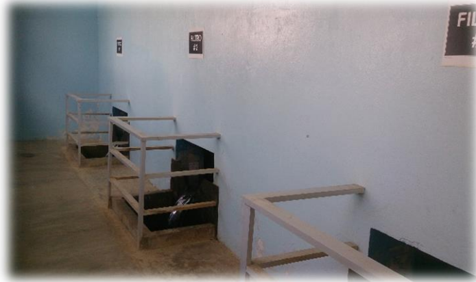
Figura 6 Área de filtros de la Planta de tratamiento de agua "Uchupucún"
