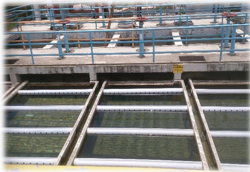
Figura 5 Sedimentador de la Planta de tratamiento de agua "Uchupucún" Fuente: Autora
