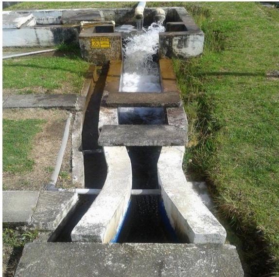
Figura 3 Ingreso de agua a la Planta de tratamiento de agua "Uchupucún". Fuente: Autora
