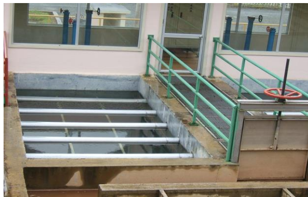
Figura 9 Sedimentadores de la Planta de tratamiento de agua "Mahuarcay"
