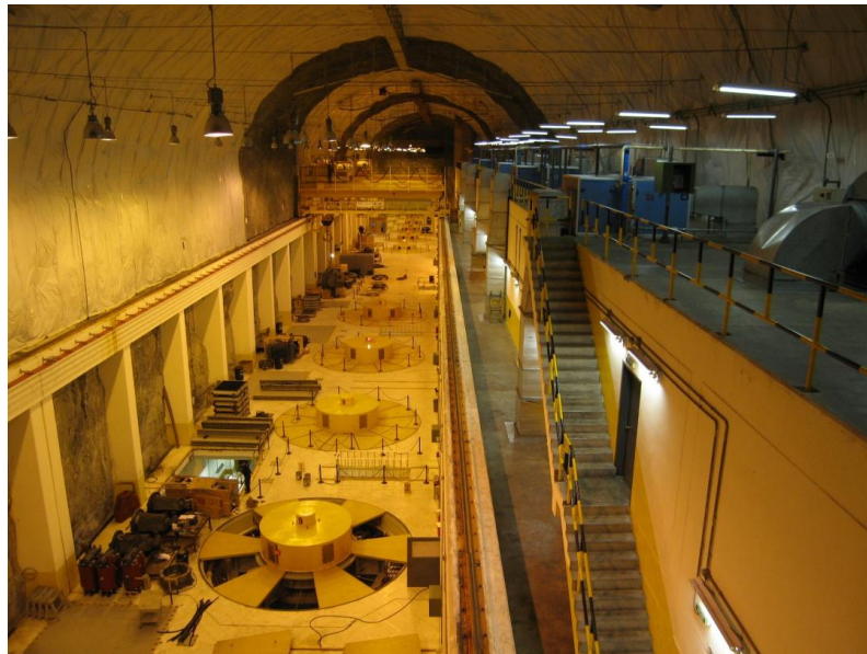
Foto 5: Casa de Máquinas de la Central Paute - Molino
