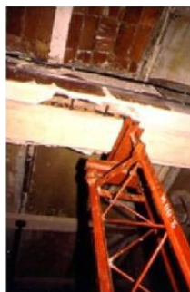
Foto 40. Los trabajos de apuntalamiento estructural resultan en muchos casos comprometidos y requieren de una definición precisa [Fotografía de Paulo Helene].
