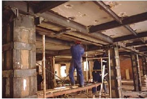
Foto 48. La sustitución funcional de estructuras de hormigón debe considerarse como un último recurso. Si bien a menudo hay que recurrir a él por resultar irreversible el proceso patológico que sufre el elemento [Fotografía de Paulo Helene].
