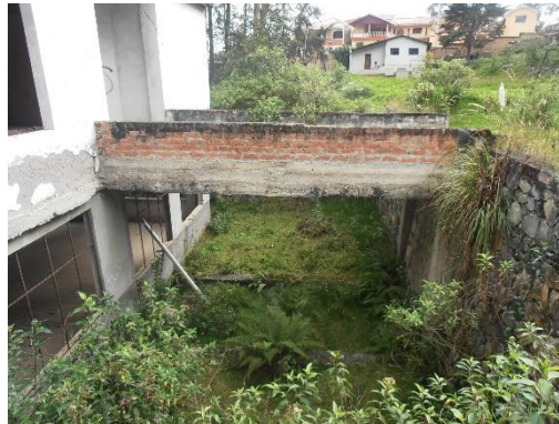
Foto 6 (Vista del Puente de Acceso a la Planta Alta del Salón Principal)
