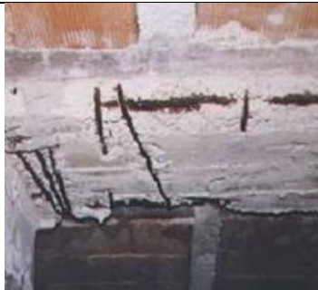
Foto 38. Corrimientos de los aceros en vigas [Fotografía de Paulo Helene].
