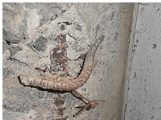
Fotos 55. Anclaje de estribo de la columna deficiente.
