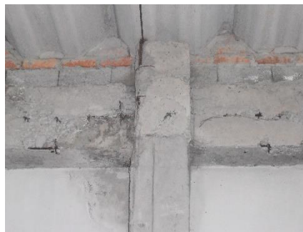
Foto 61. Disgregación de hormigón (Oquedades).
