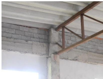
Foto 65. Presencia de corrosión en la cercha y deficiente condición del apoyo.
