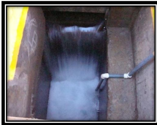
Fig. 2.8. Punto de inyección de cloro en la cámara de contacto
