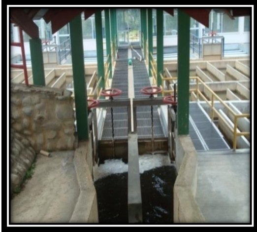
Fig. 2.5.1. Compuerta que regula el ingreso del agua a los floculadores.
