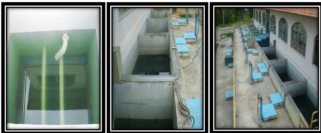
Fig. 2.7. Batería de filtros
