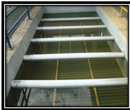
Fig. 2.10. Sedimentador en operación
