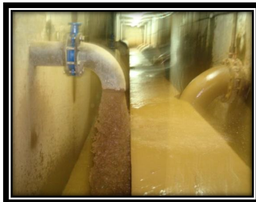
Fig. 2.11. Descarga del sedimentador
