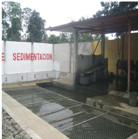
Fotografía No 5. Piscinas de sedimentación y clarificación
