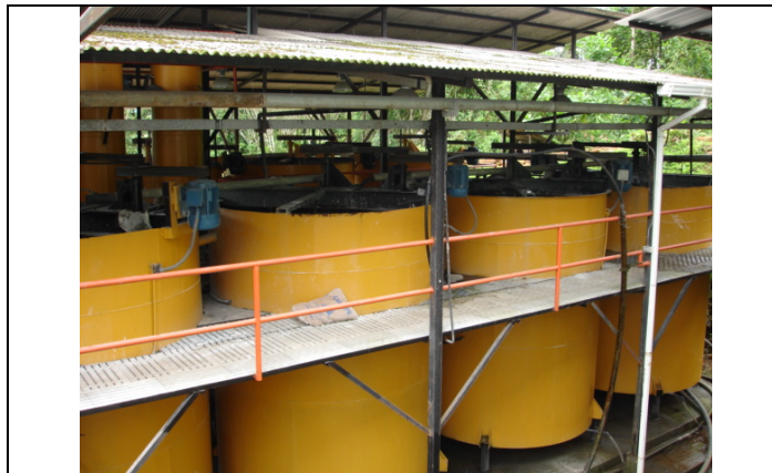
Foto 16.- reactores para el proceso de cianuración
