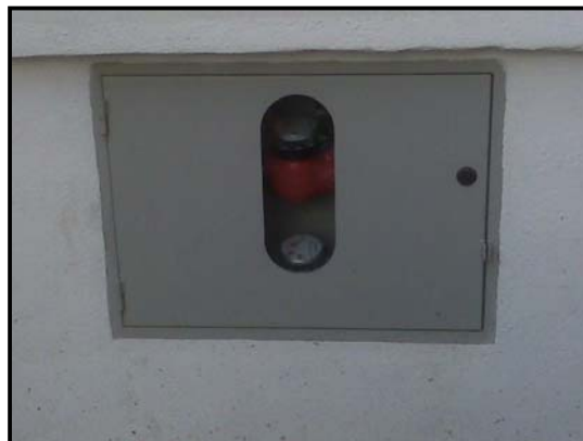
Fig. 18. Medidor de consumo de agua actual
