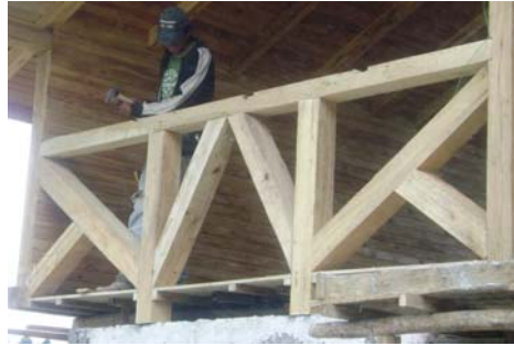
Imagen 4.24. Arriostramiento (estructura horizontal)
