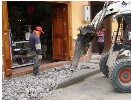
Imagen 4.14. Rotura de hormigón.
