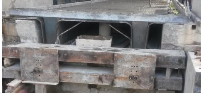
Figura 3: Elaboración de una Losa TT en la Fábrica RFV Carrasco Construcciones, se observa los cables de pretensado tensados y el fraguado del hormigón.
