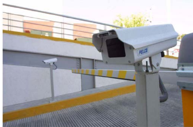
Figura 5.3. Ejemplo de una cámara de CCTV en un parqueadero.
