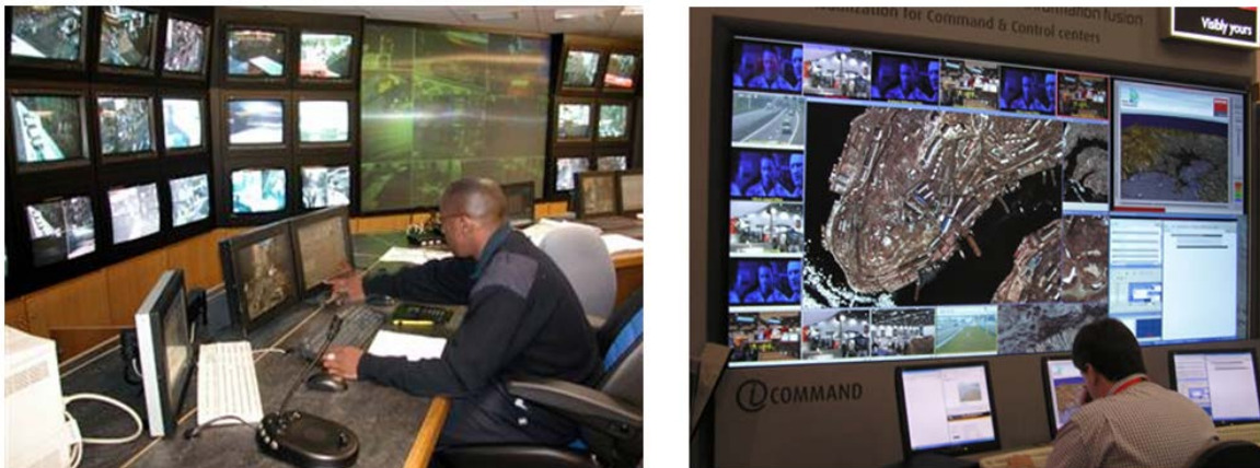
Figura 5.5. Ejemplos de Salas de Control.
