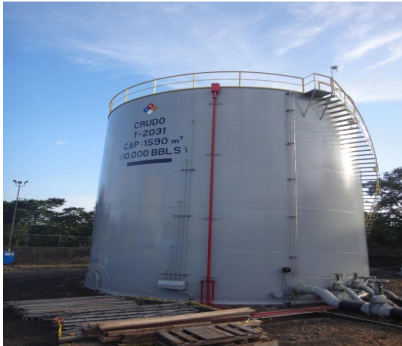
Tanque de almacenamiento de crudo de 1590 m 3
