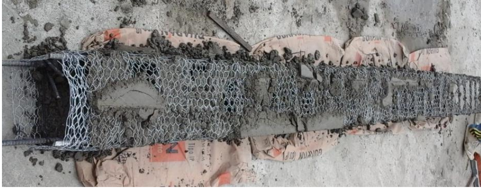
Foto. 1 Falla del revestido del encofrado por desencofrado prematuro. (Tomado del anexo 3)
