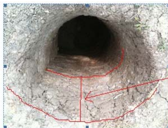
Foto 2.4 Grietas por contracción del material arcilloso
