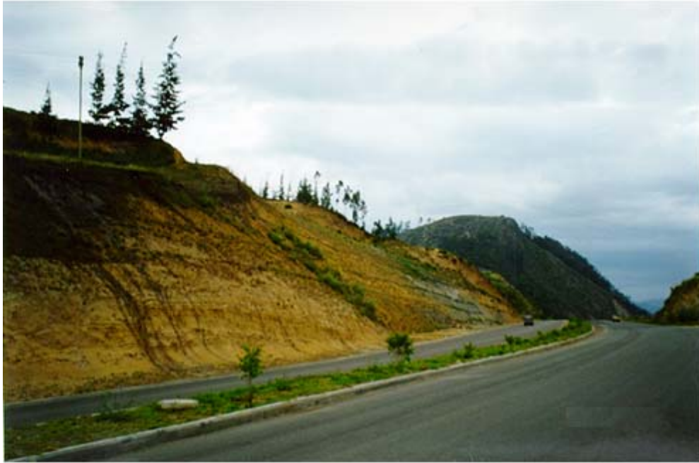
Foto 1.2. Lutitas y limolitas de la Fm. Loyola, una de las formaciones más incompetentes, no aptas para la construcción. Autopista Cuenca Azogues.
