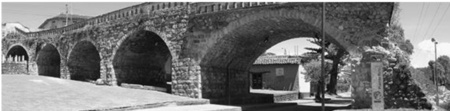
Fotografía N° 2.4. Centro Histórico de Cuenca: Puente roto.
