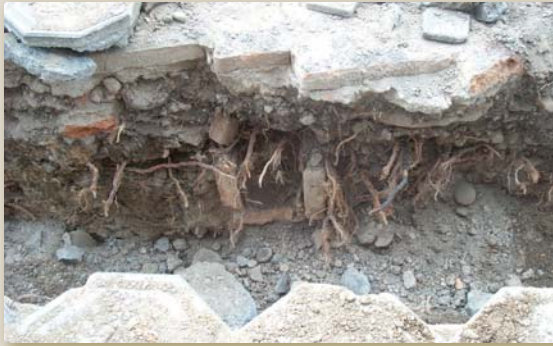
Fotografía N° 2.86,2.87 Sistema radical afectado por el corte de raíces, debido a la apertura de zanjas
