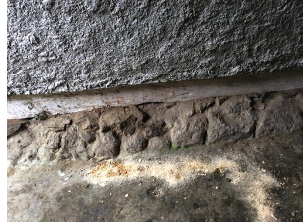
Fig. 129 Humedad en solera sobre piedras. Fuente: Investigador
