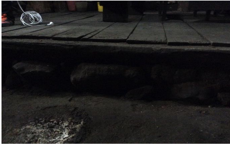
Fig. 133 Solera inferior y piso sin recubrimiento. cocina. Fuente: Investigador
