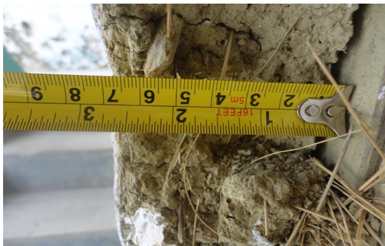
Fig. 138 Excesivo recubrimiento . Fuente: Investigador
