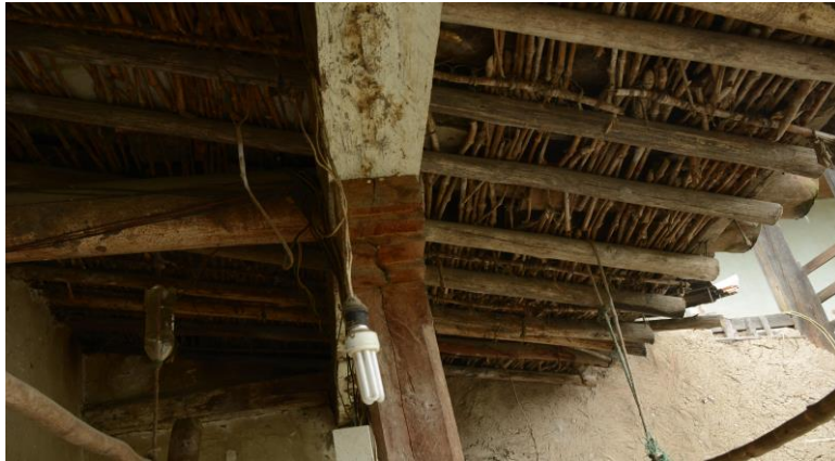
Fig. 147 instalaciones eléctricas sobrepuestas. Fuente: Investigador.
