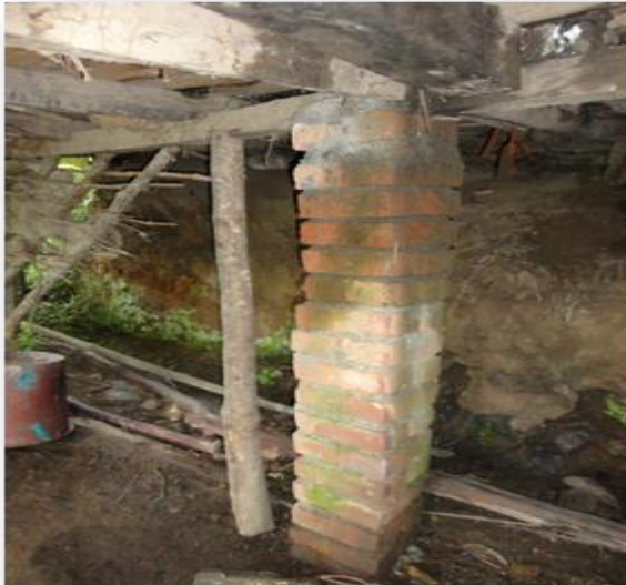
Fig. 154 Columna de ladrillo, sin refuerzo. Fuente: Investigador
