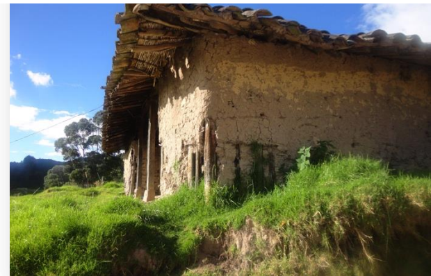
Fig. 10 Zócalo invadida por capa vegetal, por falta de mantenimiento y protección. Fuente: Investigador 2013
