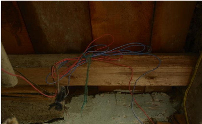
Fig. 180 Vista de instalaciones de luz improvisadas. Comunidad de Lagunas. Fuente: Investigador
