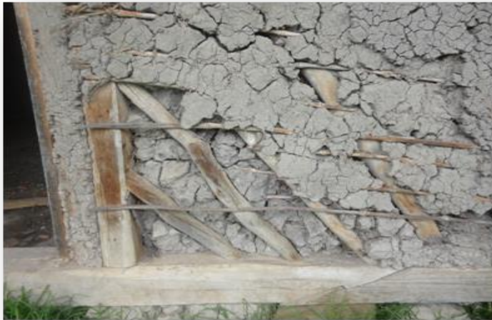
Fig. 165 Muro con desprendimientos en revestimiento y relleno. Fuente Investigador
