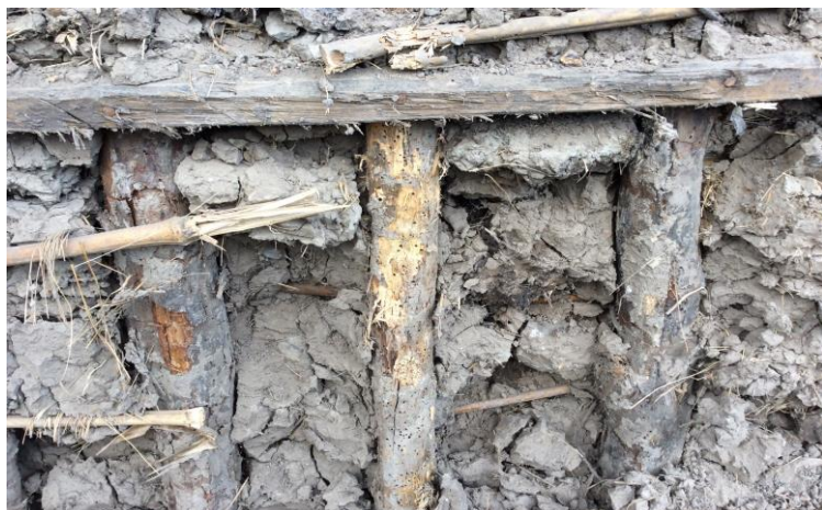
Fig. 137 Degradación de la madera . Fuente Investigador
