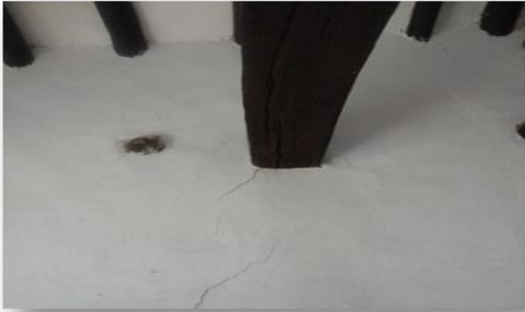
Fig. 171 Muro fisurado por acción de peso puntual de viga de gran dimensión. Fuente: Investigador
