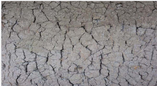
Fig. 51 Fisuras en pared. Fuente Investigador. 2013
