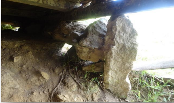
Fig. 1 Cimentación débil en construcciones de bahareque de galluchaqui. San Lucas. Fuente: Investigador 2013
