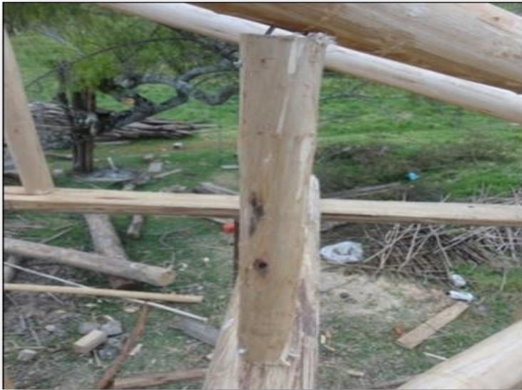
Fig. 170 deficiente unión con clavos, de viga y tentemozo. Fuente: Investigador
