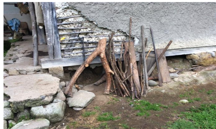
Fig. 140 Desprendimiento de revestimiento. Fuente: Investigador
