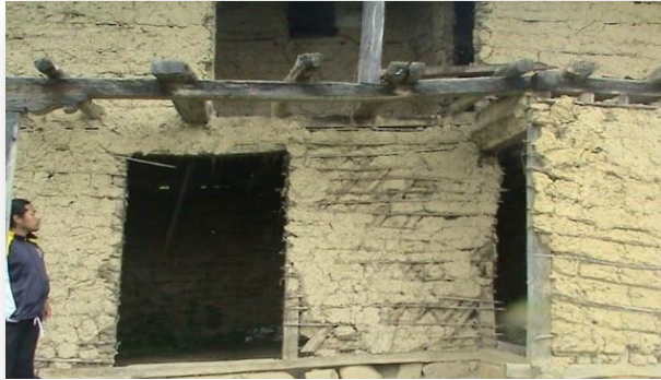
Fig. 4 Vivienda con deficiencias en muros, deficiente mano de obra, Comunidad de Pichic.
