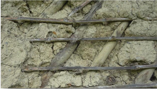
Fig. 7 Desprendimiento de material de relleno. Fuente: Investigador 2013
