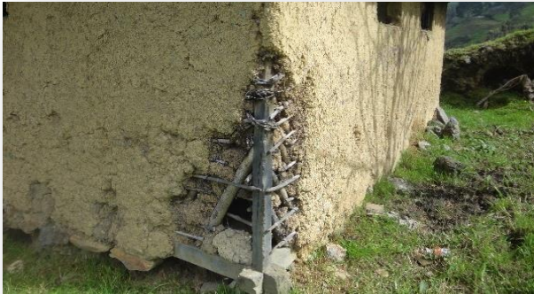
Fig. 5 Desprendimiento en el material de recubrimiento y de relleno, por acción del agua. Comunidad de Pichic.
