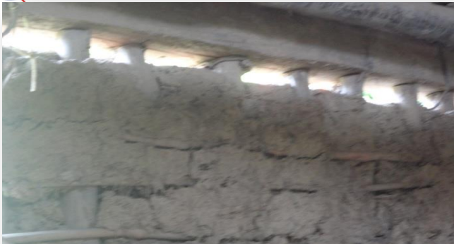
Fig. 15 Pared de Galluchaqui con relleno de tierra, se observa el asentamiento del barro generando fisuras y espacios.
