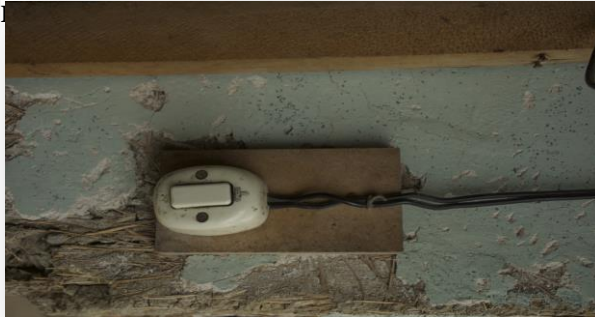
Fig. 179 Vista de interruptor de luz deficiente. Comunidad de Lagunas. Fuente: Investigador
