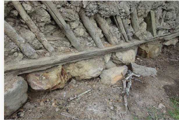
Fig. 11 Cimentación superficial y desprendimiento de relleno. Fuente: Investigador 2013
