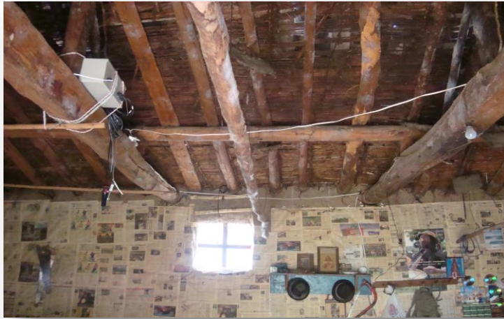
Fig. 219 Detalle equipo instalado en sala. Fuente: Investigador
