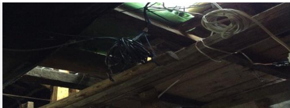
Fig. 178 Vista de cableado improvisado. Fuente: Investigador
