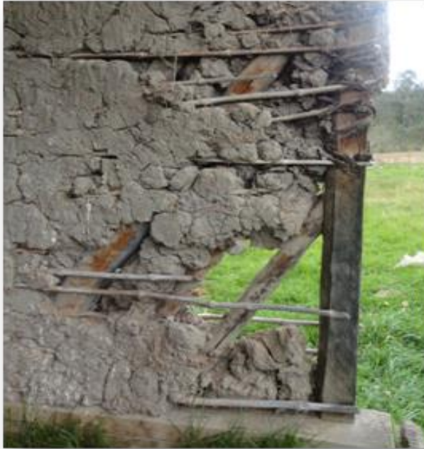
Fig. 167 Muros con desprendimiento. Fuente: Investigador
