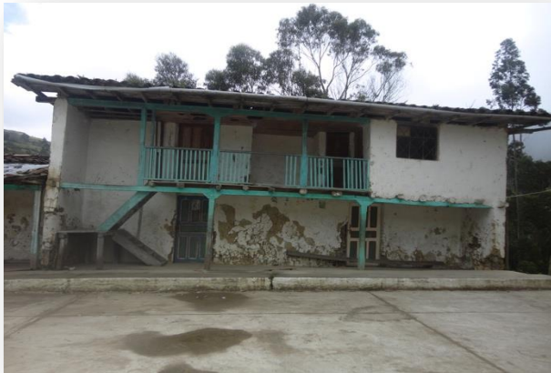
Fig. 3 Asentamiento por deficiente cimentación, comunidad de Pichic Fuente: Investigador 2013
