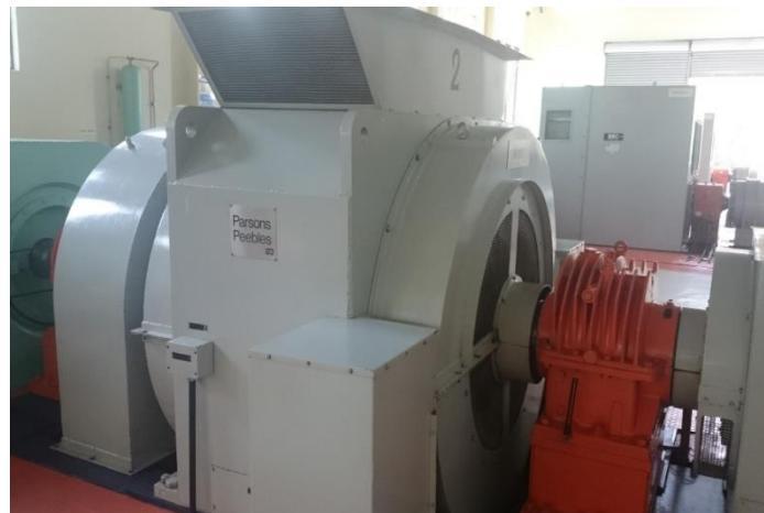
Figura 7.7: Grupo de generación 2 (Imagen tomada en el sitio).
