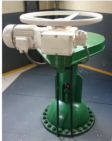
Figura 8.13: Válvula de ingreso de la turbina 1 (Imagen tomada en el sitio)
