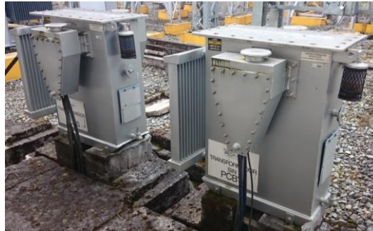
Figura 8.15: Transformadores de servicios auxiliares (Imagen tomada en el sitio)
