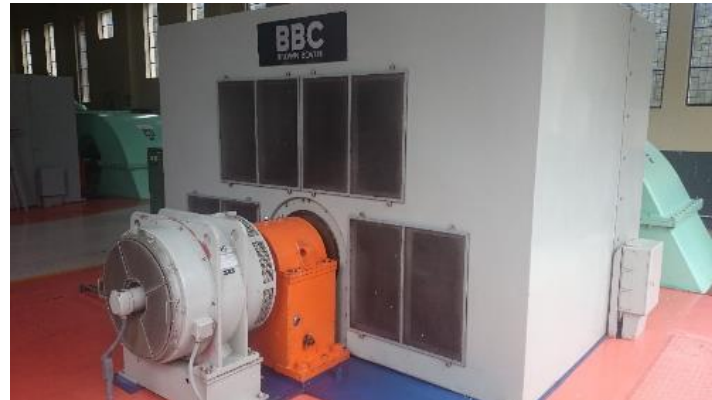
Figura 4.14: Sistema de excitación instalado en el grupo de generación 4 (Imagen tomada en el sitio).
