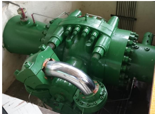
Figura 8.14: Válvula esférica de ingreso de la turbina 3 (Imagen tomada en el sitio)
