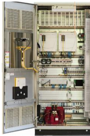
Figura 4.21: Gabinete de instalación del sistema de excitación ABB UNITROL 6080 [22].
