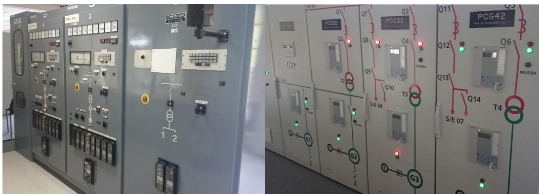
Figura 8.19: Tableros con relés electromecánicos (izquierda) y nuevos tablero de protección digital (derecha) (Imagen tomada en el sitio).
