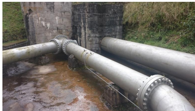
Figura 6.4: Tuberías para alimentación de los grupos de generación (Imagen tomada en el sitio).
