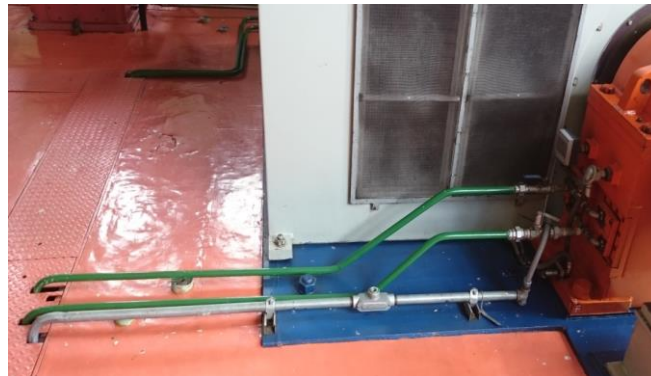
Figura 8.12: Sistema de tuberías de lubricación de los cojinetes de las unidades 3 y 4 (Imagen tomada en el sitio)
