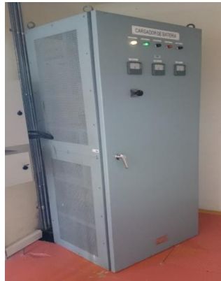
Figura 8.18: Cargador de baterías para alimentación de corriente continua. (Imagen tomada en el sitio)
