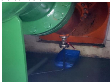
Figura 8.16: Recipiente para recoger fugas de aceite de la válvula esférica de la unidad 3. (Imagen tomada en el sitio)
