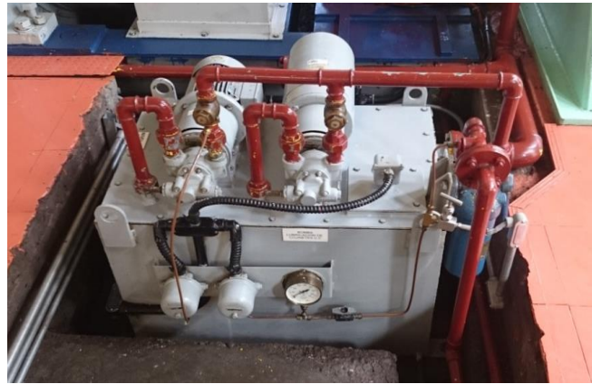
Figura 8.11: Bombas de lubricación unidades de generación 1 y 2 (Imagen tomada en el sitio)
