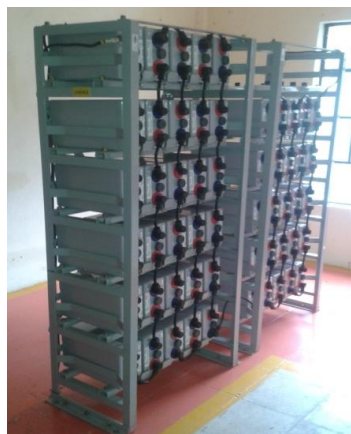
Figura 8.17: Banco de baterías de la central Saucay. (Imagen tomada en el sitio)
