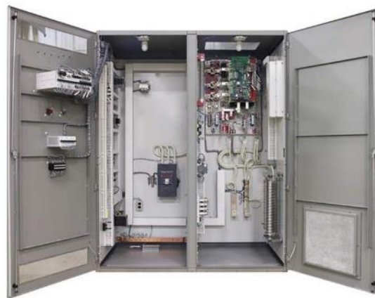
Figura 4.19: Gabinete de instalación del sistema Basler DECS 400 [18].
