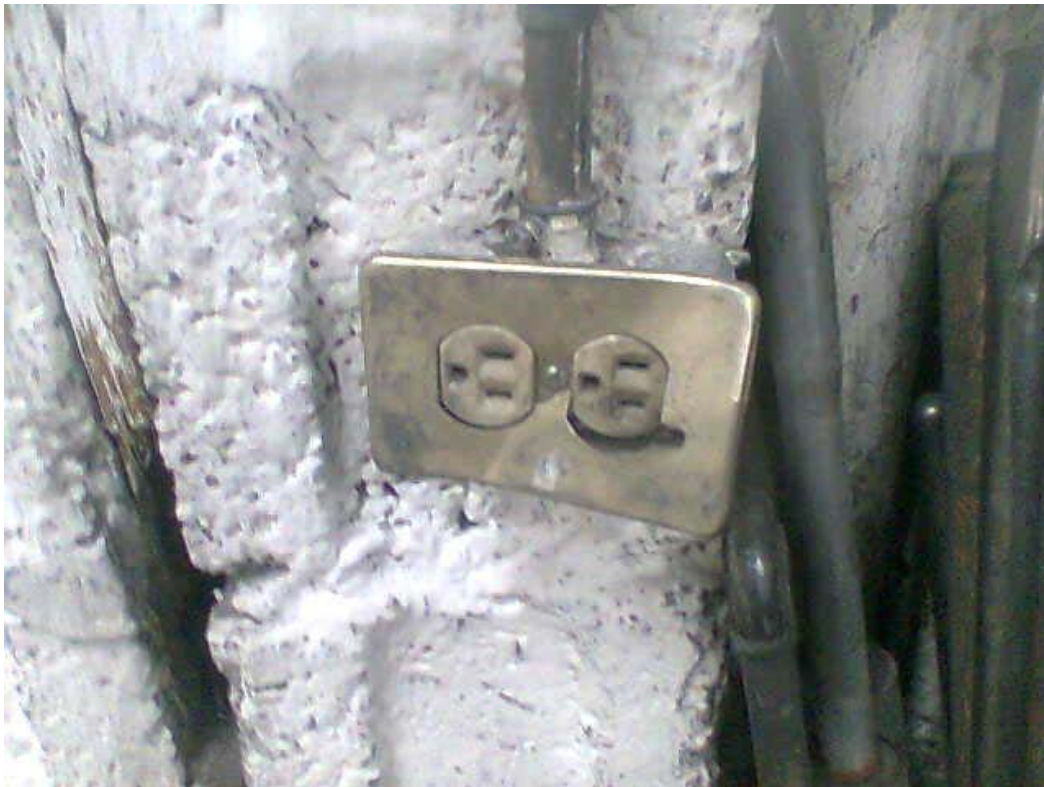
Foto 10: Instalaciones eléctricas defectuosas.
