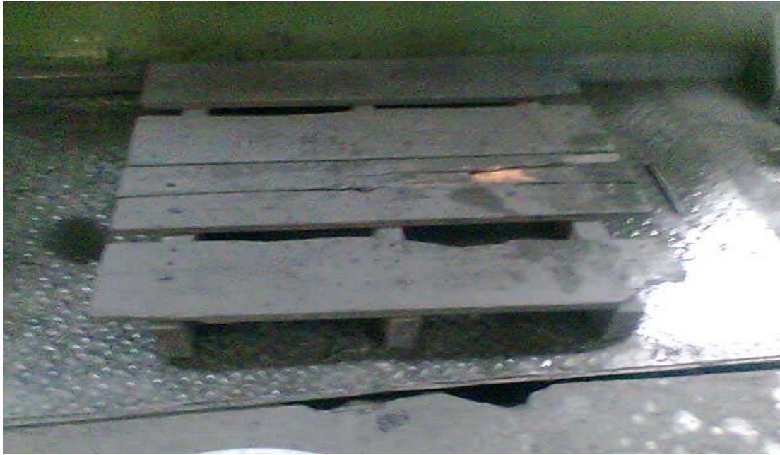
Foto 12: Tarima en mal estado.
