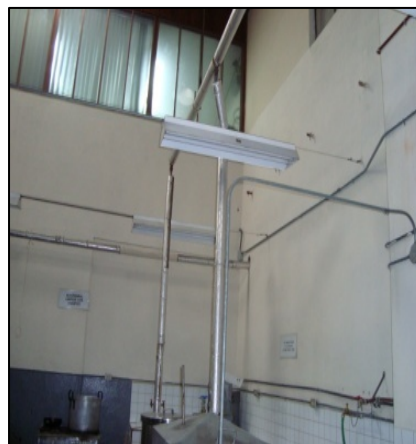
Fig.13b.- Tuberías del Laboratorio de Conservas.
