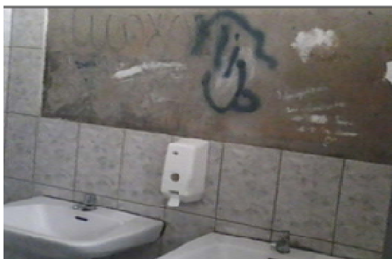
Fig.16.- Espejo del baño de la Facultad completamente roto.
