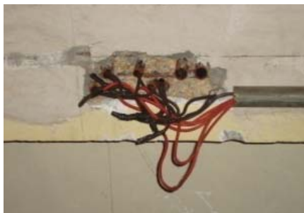
Fig.7a.- Cables desprotegidos en el Laboratorio de Operaciones Unitarias.
