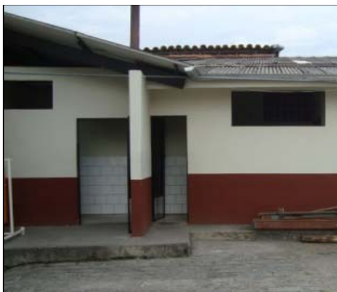
Fig.15.- Batería Sanitaria ubicada en el Tecnológico que no cuenta con señalización.
