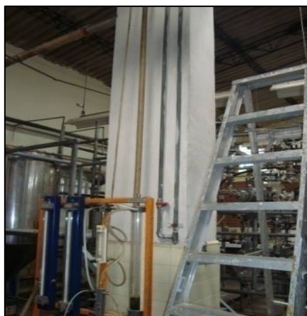
Fig.13a.- Tuberías del Laboratorio de Ingeniería Química.
