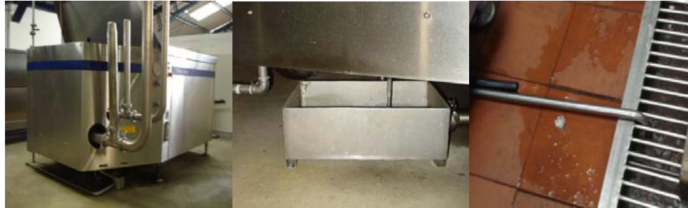
Descargas del agua del Homogenizador a la alcantarilla
