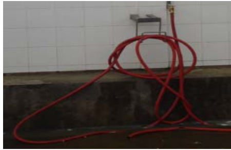
Manguera sin reductor de presión
