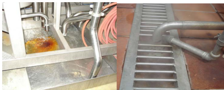
Descarga de condensados en las áreas de pasteurización y UHT
