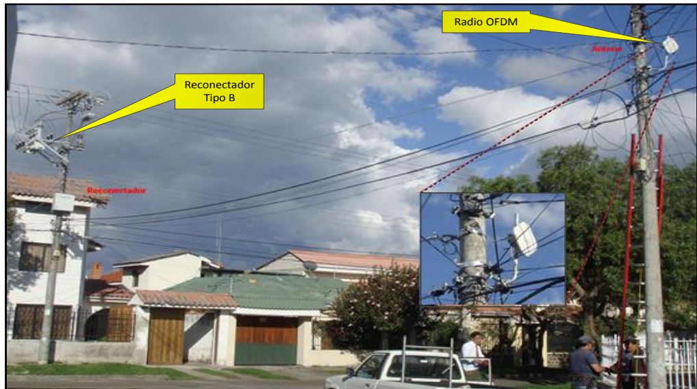
Figura 6.7: Reconector Tipo B del alimentador 0324 ubicado en la Av. Cacique Chaparra, integrado al sistema de Monitoreo y Control Remoto de la red de distribución de CENTROSUR [Autor].
