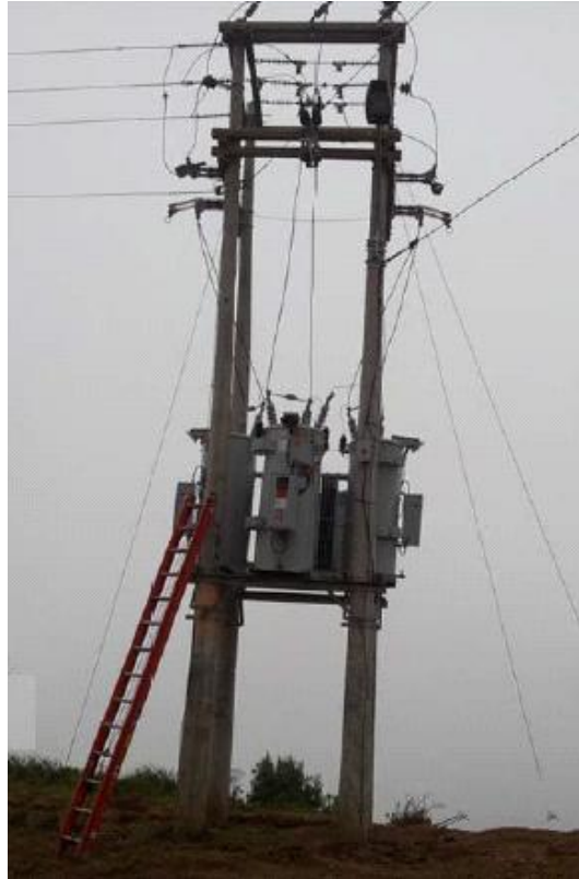
Figura 3.18.Reguladores de tensión de línea [Autor]
