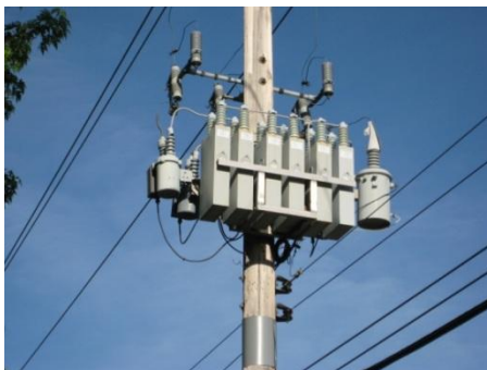
Figura 3.17. Banco de capacitores conmutado montado en poste
