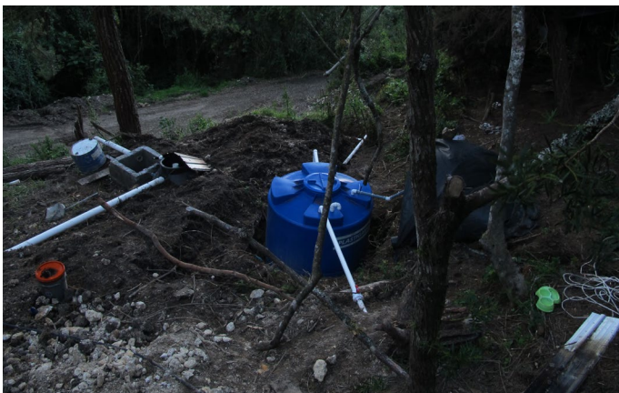
Foto_150: Tanque de reserva conectado a una bomba hidroneumática que regresa el agua limpia a la vivienda.
