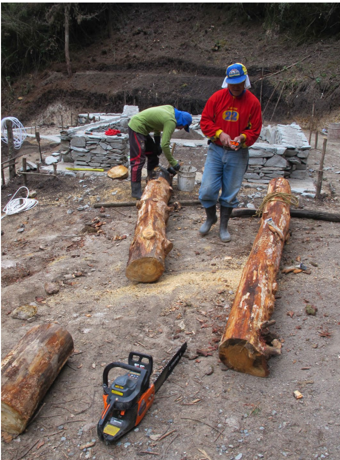
Foto_76: Para nivelar se coloca una capa de hormigón. Las columnas de madera se asientan en la base y se aseguran con varillas de hierro.
