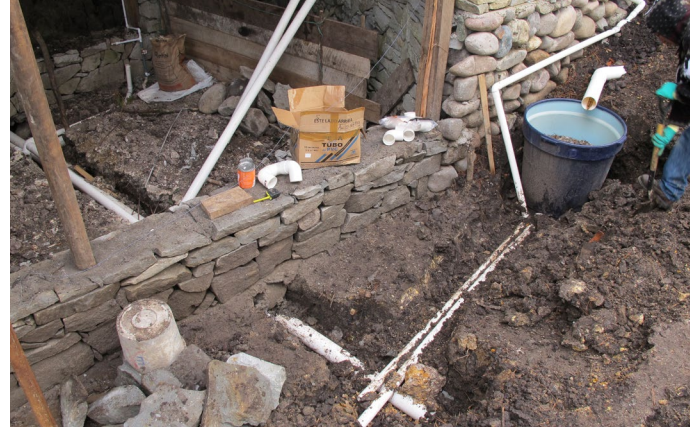
Foto_146: El agua lluvia se recolecta y se pasa por un filtro de arenas (para filtros de agua) que limpia las impurezas del agua.
