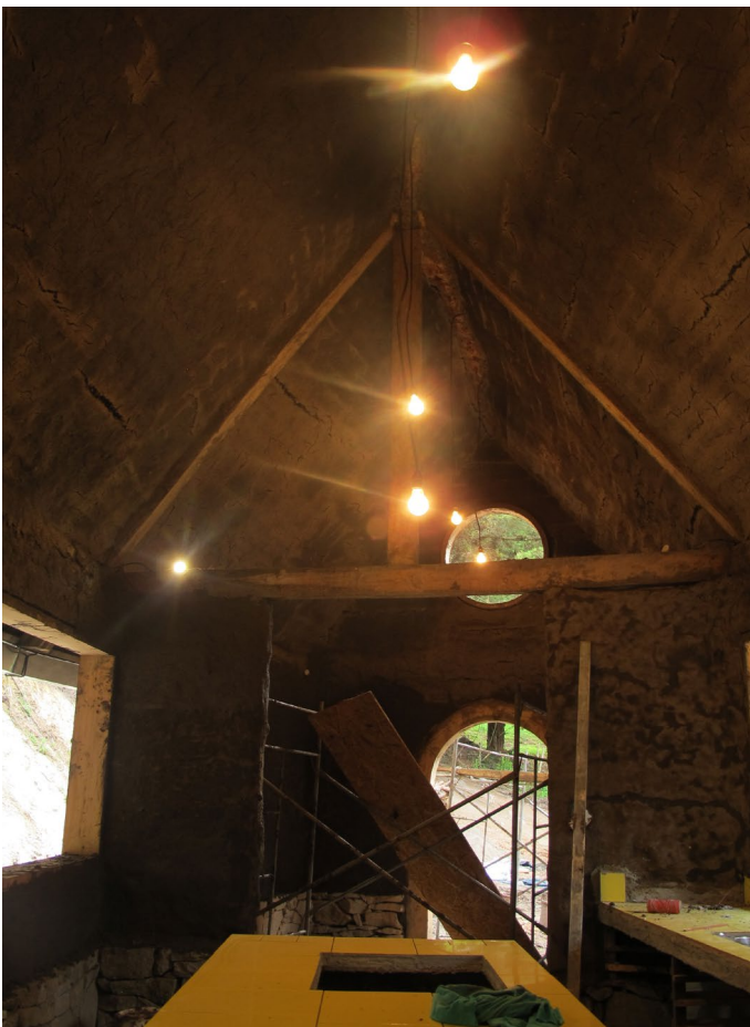
Foto_202: Aparecen grietas en el secado del barro.
