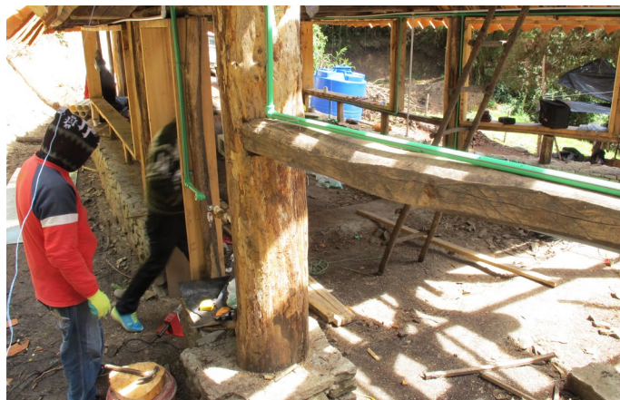
Foto_136: Instalaciones de agua.
