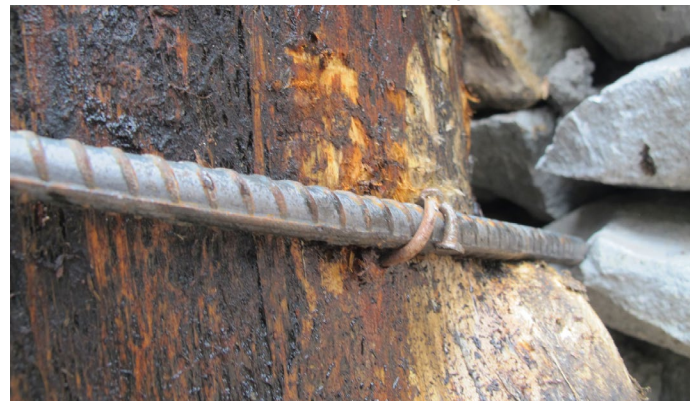
Foto_79: Para asegurar las columnas se utilizan varillas de hierro de 10mm de espesor enganchadas con clavos de 2pul.
