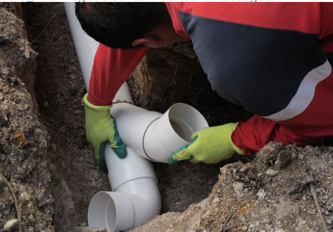
Foto_144: Detalle del desagüe.
