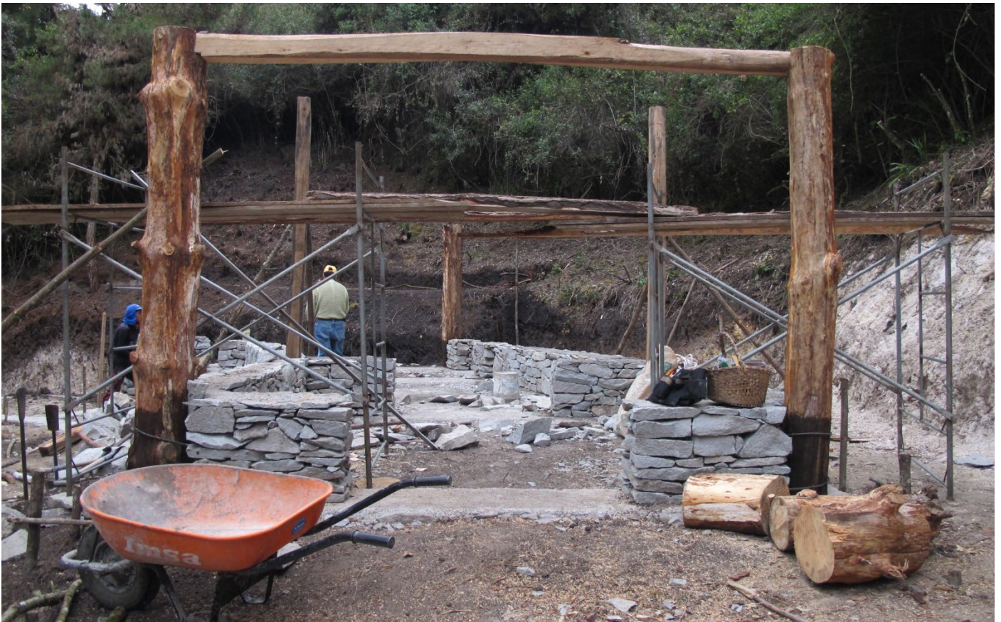
Foto_84: En la superficie de las columnas se asientan las vigas, lo importante es que los destajes eviten separaciones entre los elementos.
