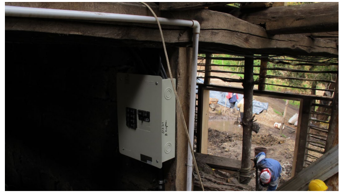
Foto_157: Caja de medidor.
