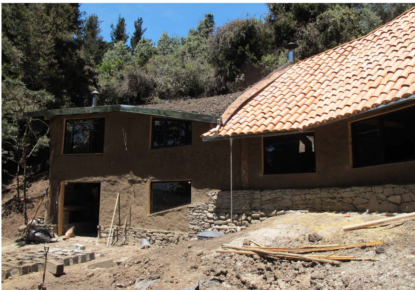
Foto_216: Las puertas y ventanas llegaron armadas y listas para ser ensambladas en obra.
