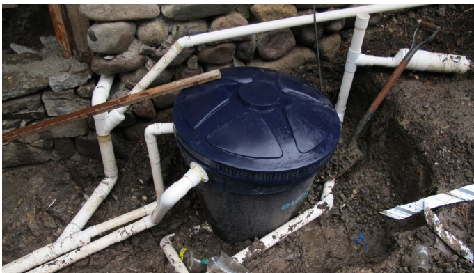
Foto_149: Tanque de filtración.
