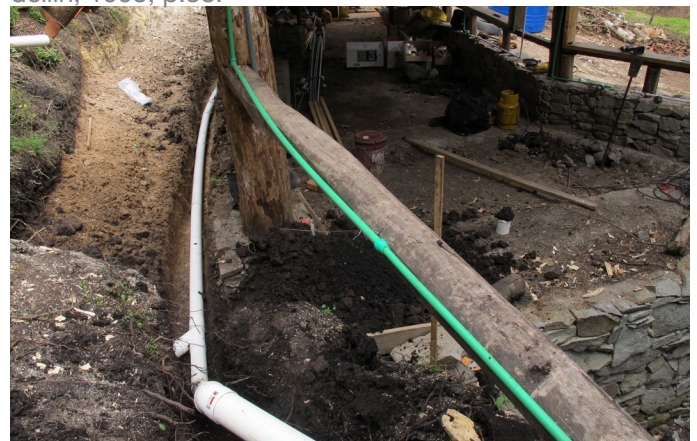
Foto_137: Desagüe y agua caliente.
