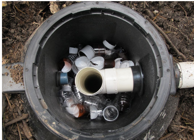
Foto_153: Detalle del biodigestor.
