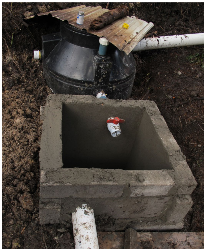
Foto_154: Caja de lodos.
