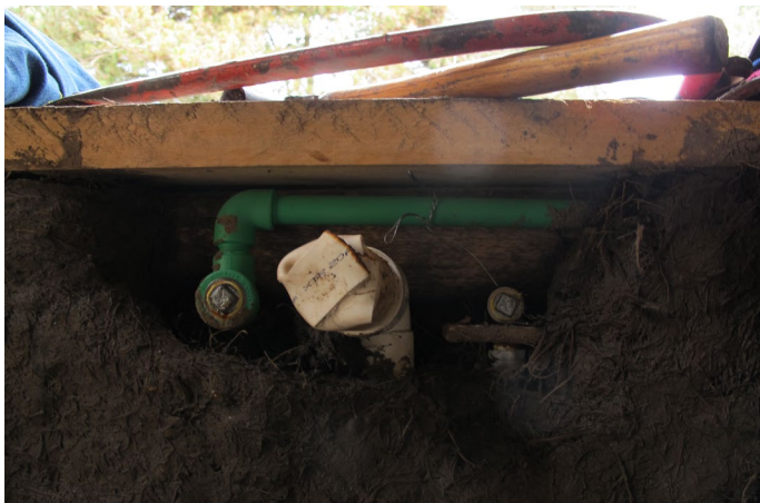
Foto_135: Terminales de agua caliente (verde), agua fría (blanco) y el desagüe (blanco mas grueso).
