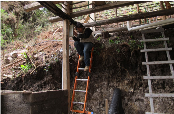
Foto_155: Técnico eléctrico.
