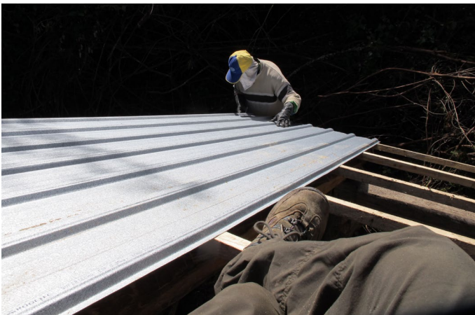
Foto_122: Planchas de zinc (súper techo).
