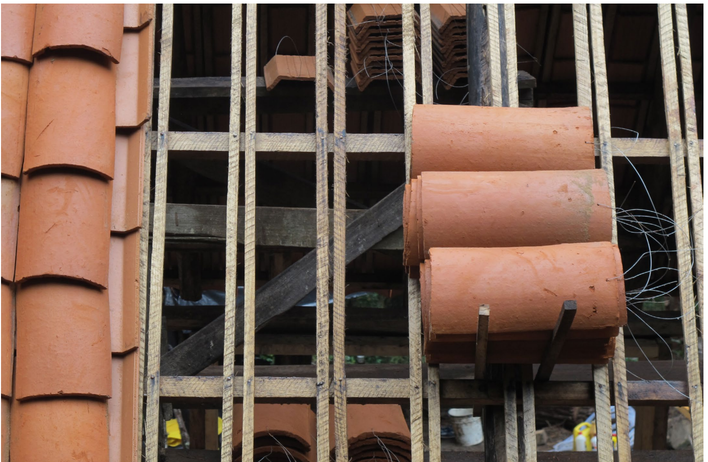
Foto_115: Se pueden clavar tirillas perpendiculares al entriplado para poder asentar las tejas.
