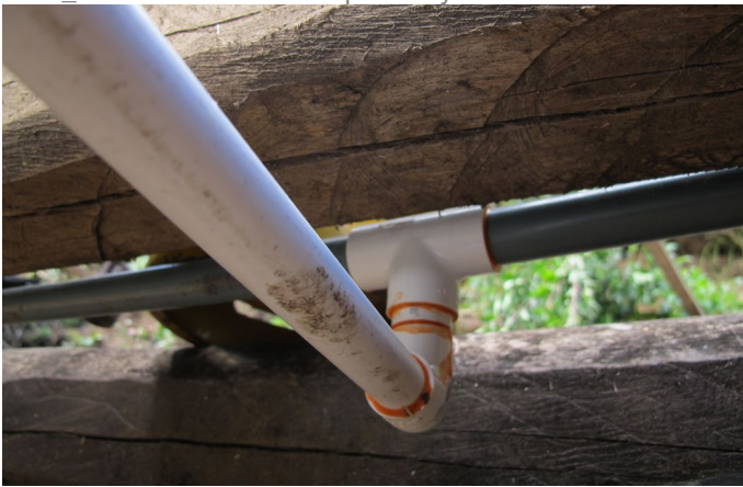
Foto_134: Detalle de las instalaciones de agua fría.
