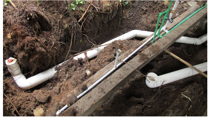
Foto_145: Agua fría, agua caliente y desagües de un baño.
