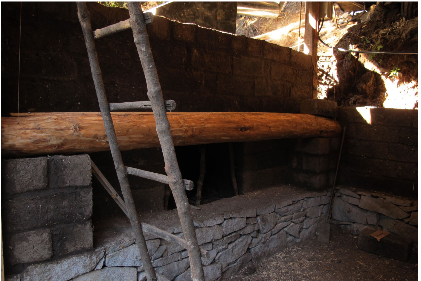
Foto_180: La chimenea en proceso de la construcción, utilizando la misma piedra del sobrecimiento como base, los adobes como mampostería y un tronco de pino como dintel (únicamente asentado y embebido en el adobe).
