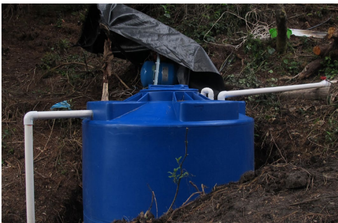
Foto_151: Tanque de reserva.
