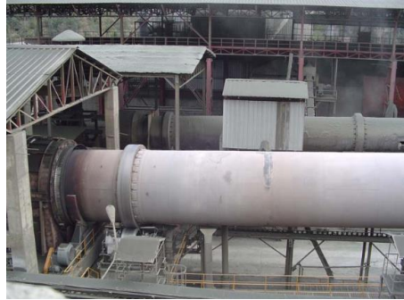
Figura 10. Horno Rotativo de la Planta Industrial Guapán.
