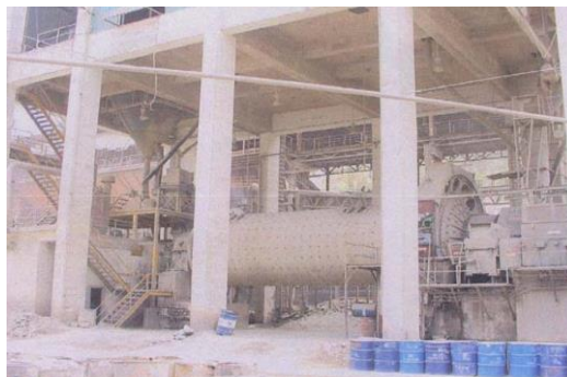
Figura 11. Molienda de Acabado de la Planta Industrial Guapán.
