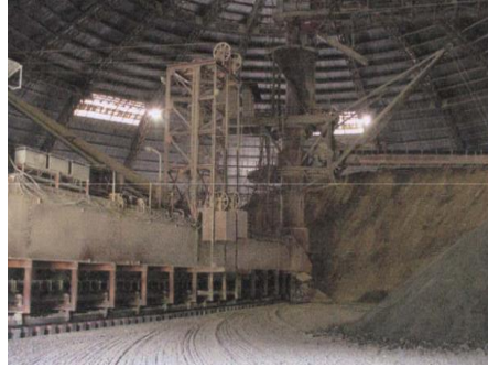
Figura 7. Parte interna del Prehomogenizador de la Planta Industrial Guapán.
