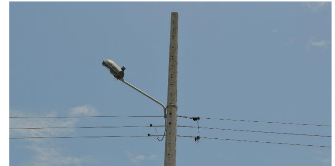
FOTOGRAFÍA N° 3.30 ISLA PONGALILLO – CANTÓN SANTA ROSA Luminarias (Postes de energía eléctrica)
