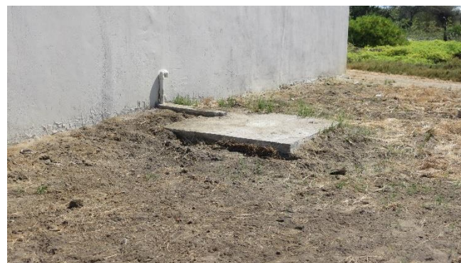
FOTOGRAFÍA N° 3.36 ISLA PONGALILLO – CANTÓN SANTA ROSA Pozo Séptico – Casa Comunal
