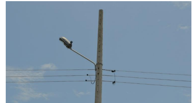
FOTOGRAFÍA N° 1.29 ISLA PONGALILLO – CANTÓN SANTA ROSA Abastecimiento de energía eléctrica a las viviendas.
