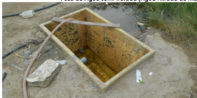
FOTOGRAFÍA N° 3.32 ISLA PONGALILLO – CANTÓN SANTA ROSA Pozo de Agua semi-tratada (Agua Filtrada de Mar)
