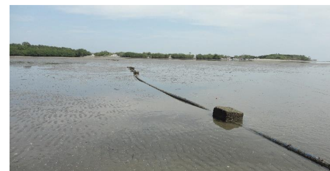
FOTOGRAFÍA N° 3.33 ISLA PONGALILLO – CANTÓN SANTA ROSA Red de Conducción de Agua Potable
