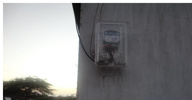
FOTOGRAFÍA N° 3.31 ISLA PONGALILLO – CANTÓN SANTA ROSA Medidor de Energía Eléctrica (Domiciliaria)
