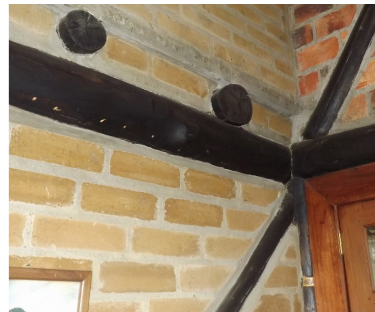
fig. 43a Junta sobredimensionada
