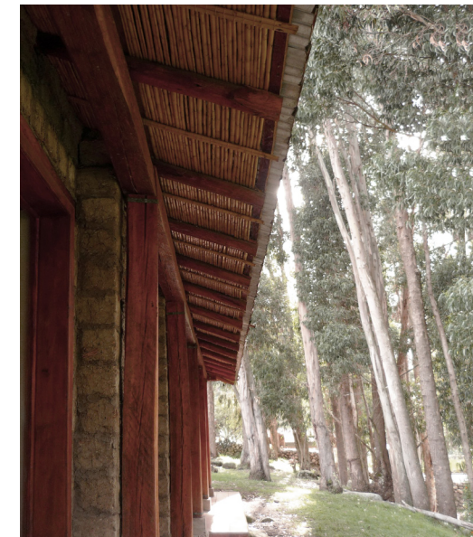
fig. 71 - Cubierta Exenta de estructura de muros, Casa de la Cultura del Río, Cuenca.
