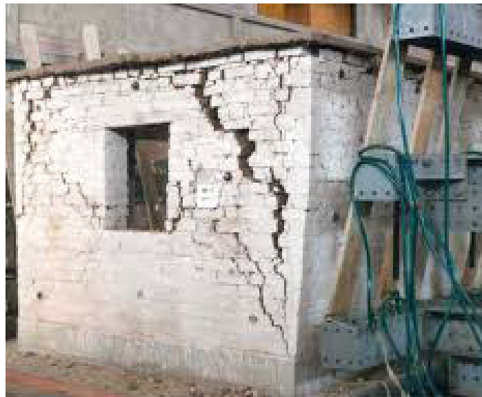
fig. 65 - Fisuras en vanos, construcción en Adobe
