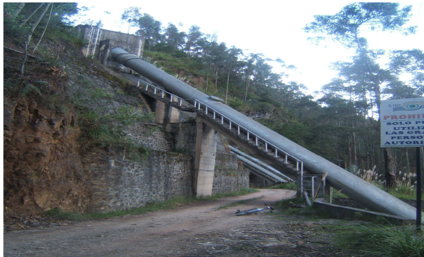
Figura 11. Tubería forzada Central Saymirín. > 2700. 2010.
