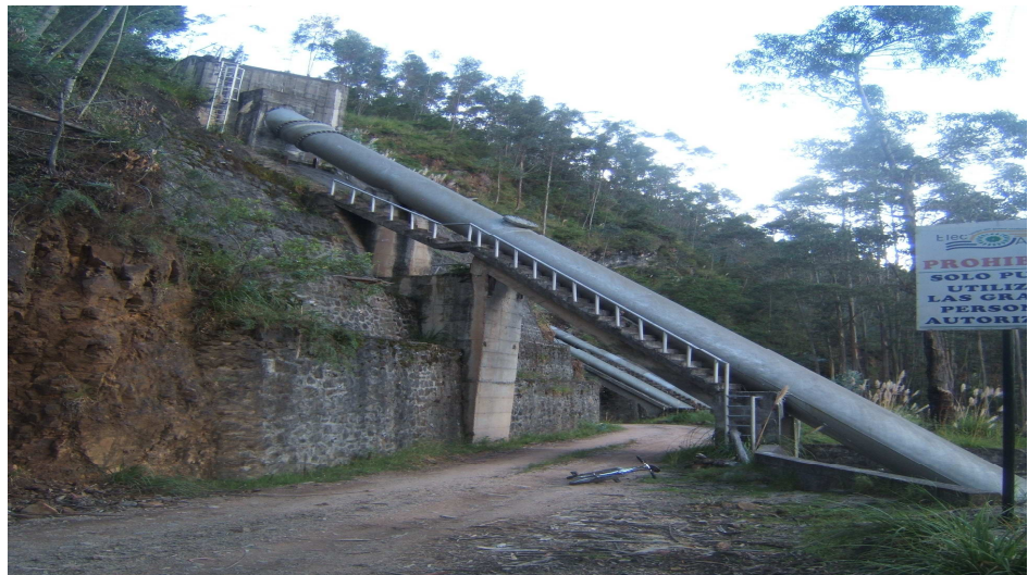
Figura 11. Tubería forzada Central saymirin. > 2700. 2010.
