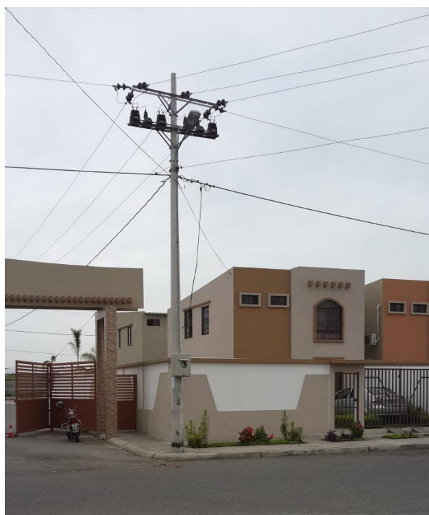
Gráfico 4.13. Medidor centralizado Urbanización Panorama - Durán
