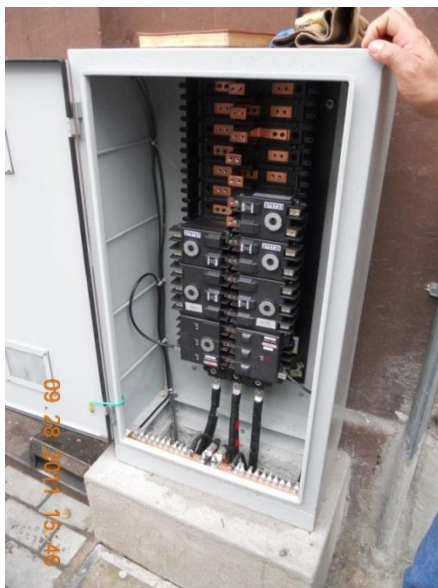
Gráfico 5.8. Tablero de medidores y protección del sistema de telegestión utilizando PLCs
